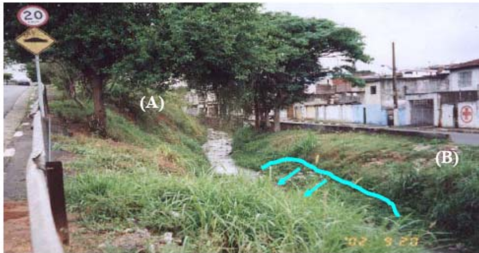
Foto 9.3.1-5 – Córrego tributário apresentando solapamento das margens (linha azul).
