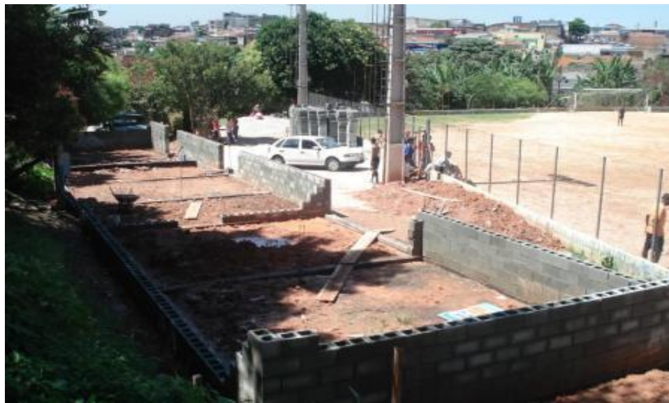
VISTA GERAL DO EQUIPAMENTO
