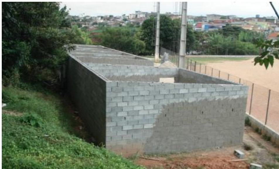
VISTA GERAL DO EQUIPAMENTO
