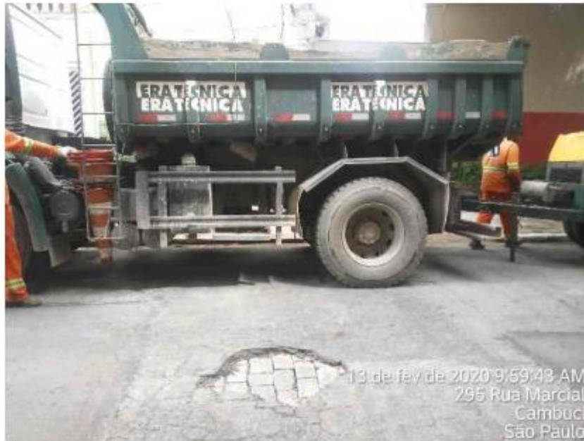
(Foto antes do serviço ser executado, Rua Marcial, 295)
