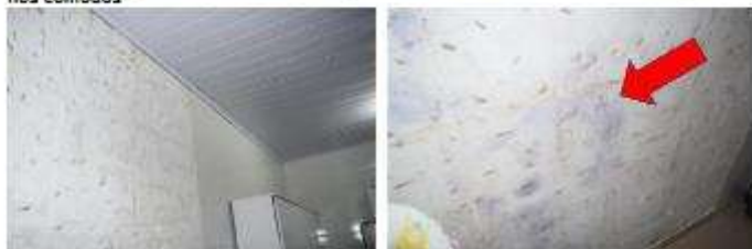
Fotografia 12. Imagem junto à residência do Conjunto Habitacional Água Branca. Observa-se manchas e surgimento de mofo e infiltrações decorrentes da ausência de ventilação e insolação nos cômodos
