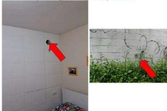
Fotografia 18. Imagem junto à residência do Conjunto Habitacional Água Branca. Observa-se abertura executada por morador junto ao muro para ventilação do cômodo.
