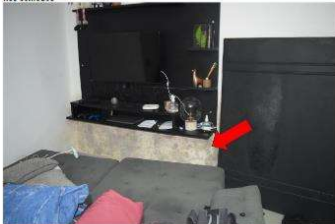
Fotografia 11. Imagem junto à residência do Conjunto Habitacional Água Branca. Observa-se manchas e surgimento de mofo e infiltrações decorrentes da ausência de ventilação e insolação nos cômodos
