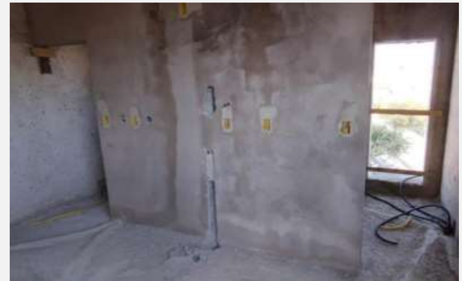
HIS 27 – Instalação dos conduites nos pisos e paredes até o 7º pavimento.
