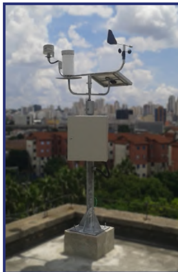
Estação instalada em Santana, Zona Norte
