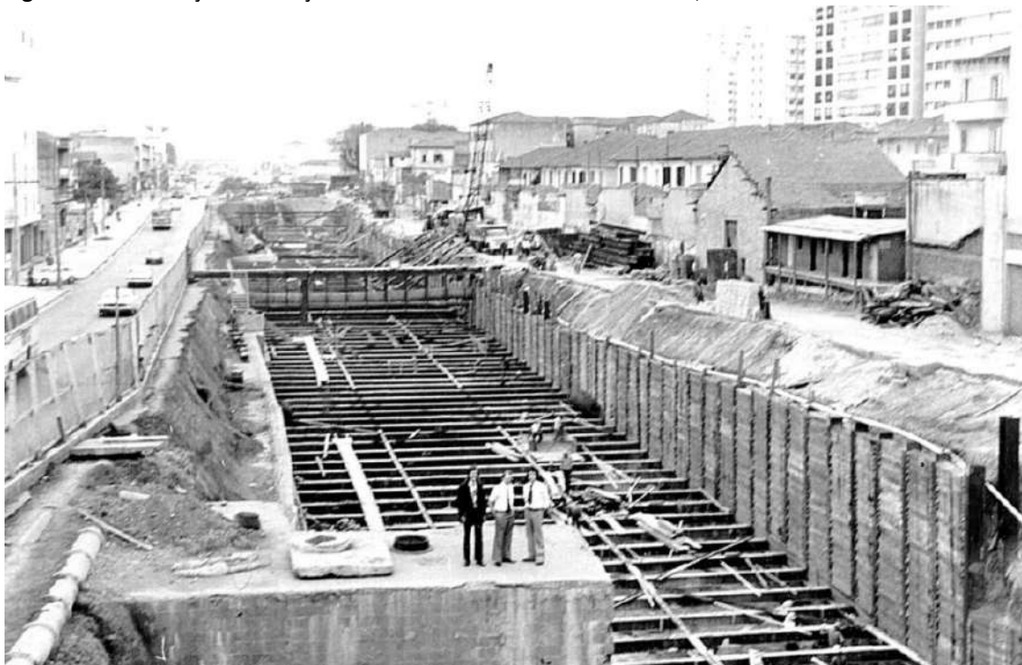
Figura 53 - Construção da Estação Vila Mariana do Metrô de São Paulo, sem data.
