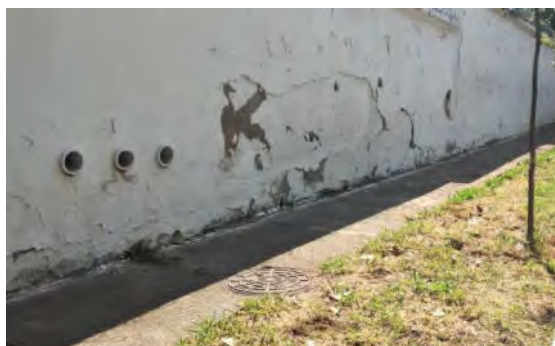
Foto 9.1.7.5-11 - Saída de escoamento de águas pluviais na área externa do muro da rua Monsenhor Alberto Pequeno.
