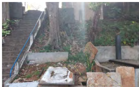
Foto 9.1.7.5-4 - Erosão em declive com pequena escada d'água na área permeável para redução da velocidade.
