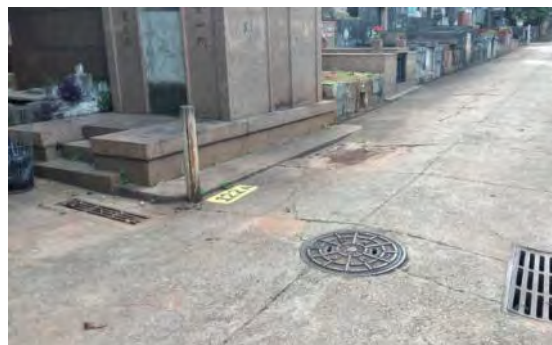
Foto 9.1.7.5-2 - Bueiros ligados à galeria subterrânea de águas pluviais na Quadra 122A
