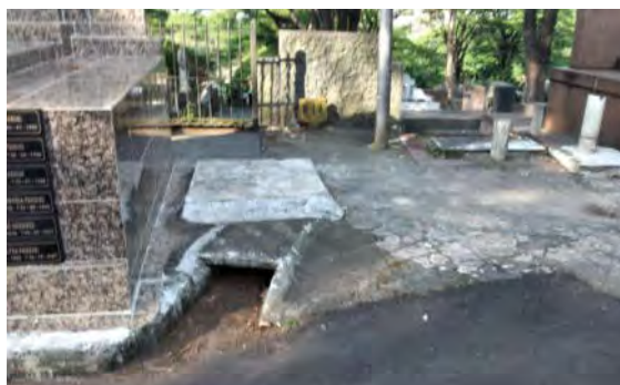
Foto 9.1.7.5-3 - Canaleta para escoamento em declive, próxima à Capela.
