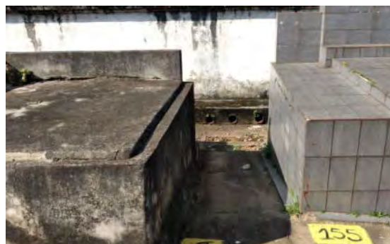
Foto 9.1.7.5-12 - Saída de escoamento de águas pluviais na área interna do muro da rua Monsenhor Alberto Pequeno.
