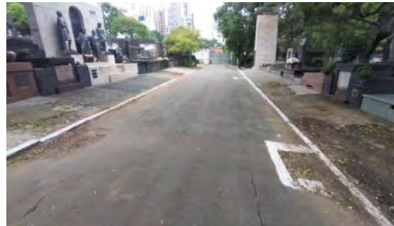
Foto 9.1.7.5-6 - Bueiros entupidos na Quadra 32.
