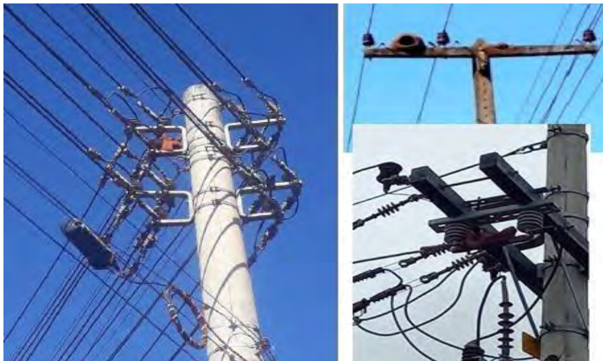
Figuras 3,4,5 - Imagens da proximidade dos ninhos de João-de-barro ( Funarius rufus ) dos elementos energizados
