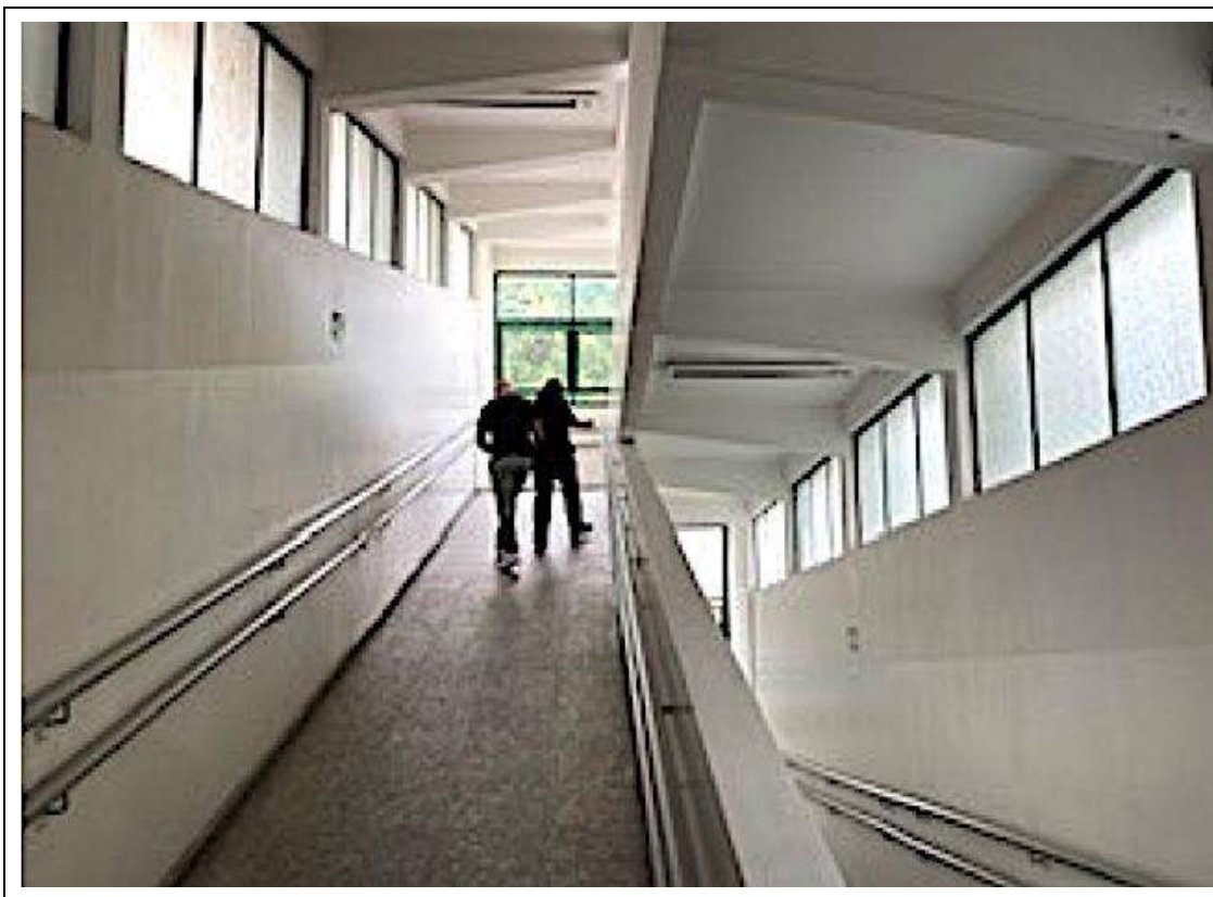
Figura Nº 7: Hospital e Maternidade Dr. Ignácio Proença de Golvêa. Rampas de acesso aos andares superiores. A declividade excessiva não permite a circulação de camas e macas.
