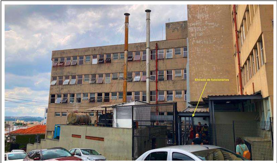
Figura Nº 31: Hospital Tide Setúbal. Local das caldeiras e entrada de funcionários do Hospital, na lateral da rua João Augusto Moraes.
