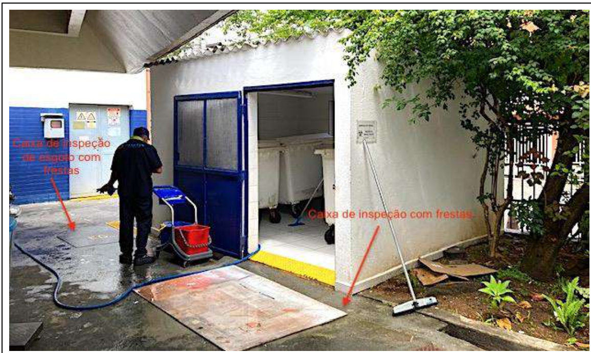
Figura Nº 24: Hospital Municipal Dr. Alexandre Zaio. Depósito de lixo infectante. Piso e drenagem inadequados e caixas de inspeção instaladas na frente do depósito dificultando a limpeza.
