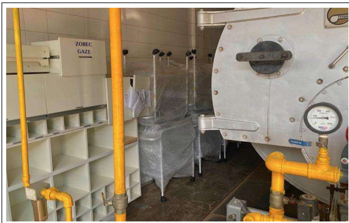
Figura Nº 45: Hospital Municipal e Maternidade Mario Degni. Sala das caldeiras utilizada para depósito de mobiliário, aumentando o risco de acidentes.
