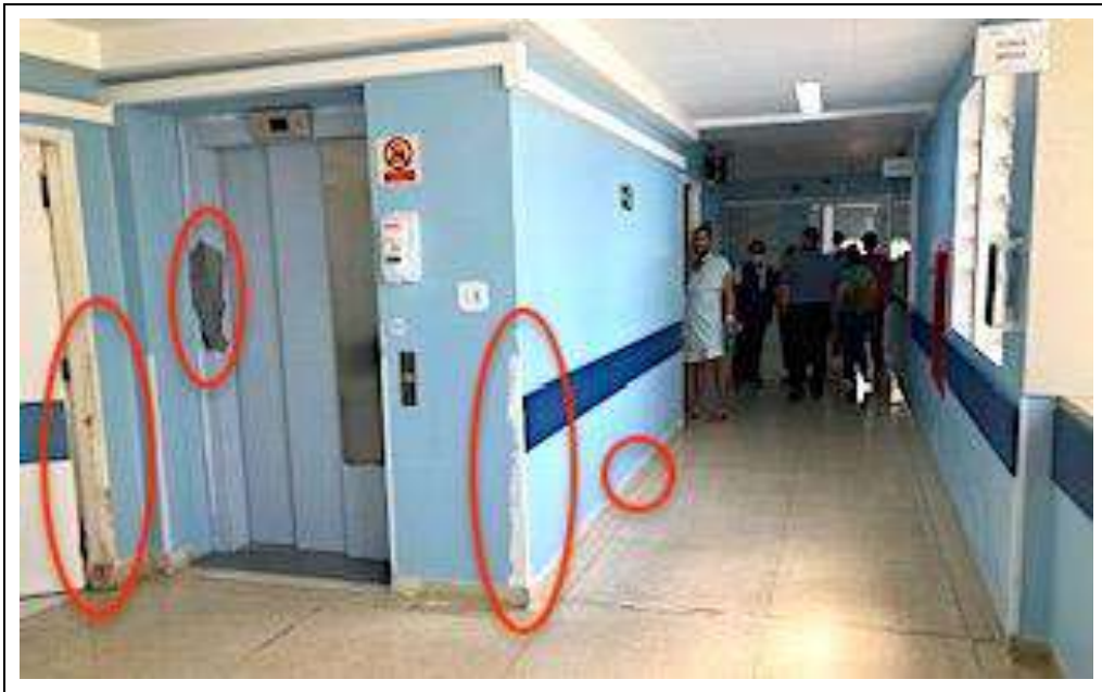
Figura Nº 6: Corredor interno do Hospital e Maternidade Dr. Ignácio Proença de Golvêa. Piso, bate maca e teto inadequados, manutenção deficiente e elevador que não permite o transporte de pacientes em cama hospitalar.
