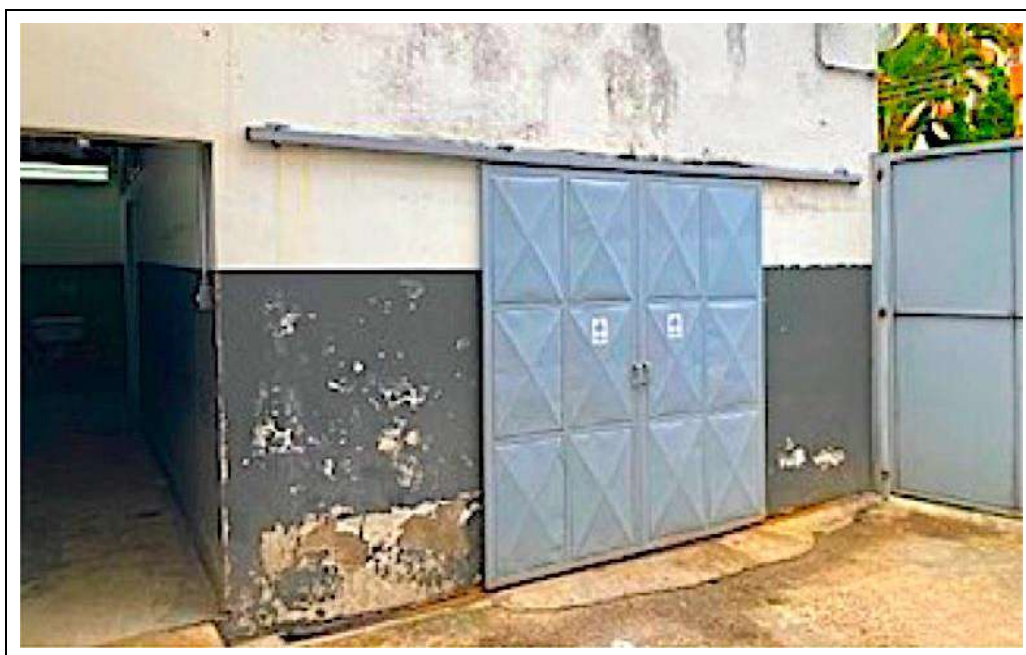
Figura Nº 8: Hospital e Maternidade Dr. Ignácio Proença de Golvêa. Disposição de resíduos infectantes em local inadequado e em desacordo com as normas da ANVISA.
