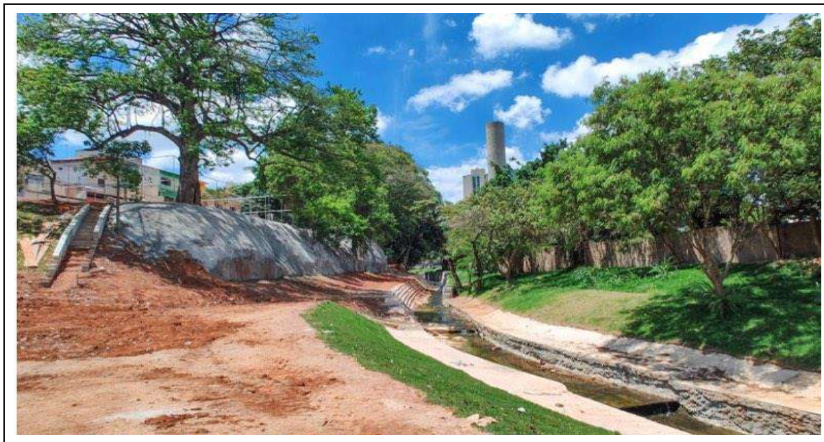
Figura Nº 66: Córrego Sem Nome ao lado do hospital, à direita da foto. À esquerda, vertente em V constitui a margem declivosa do curso d'água. Abaixo na foto e acompanhando o canal, observa-se trecho da forma de relevo Planícies Aluviais. As obras mostram a tentativa do poder público de regularizar e estabilizar o córrego, em local de relevo instável e sujeito a deslizamentos e inundação. Essa instabilidade ocorre na margem direita, oposta ao terreno do hospital, não afetando, portanto, o terreno onde ocorrerão as intervenções do Programa.
