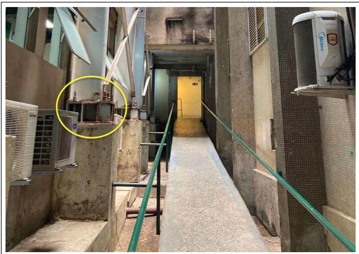
Figura Nº 32: Hospital Tide Setúbal. Acesso interno de funcionários ao interior do Hospital. No círculo amarelo, ferrugem em estado avançado da estrutura metálica, denotando falta de manutenção.
