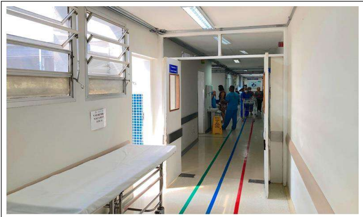
Figura Nº 43: Hospital Municipal e Maternidade Mario Degni. Corredor interno em desacordo com as normas e padrões de instalações de serviços de saúde e segurança, sobretudo com relação ao piso, teto, instalação elétrica, identificação de rotas de fuga e implantação de Projeto de Segurança Contra Incêndio e Pânico – PSCIP.
