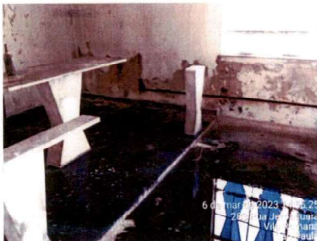
Foto 6 – Poças d'água existentes no 6º pavimento
