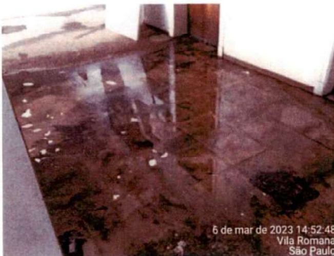
Foto 5 – Poças d'água existentes no 6º pavimento
