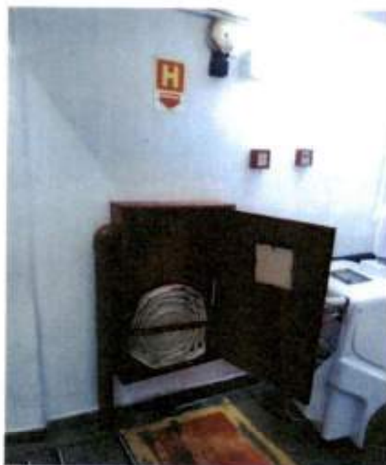
CORREDOR PRINCIPAL – HIDRANTE H-2.
