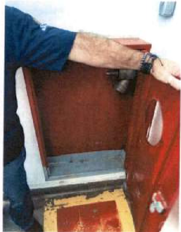
CORREDOR DA PSIQUIATRIA - HIDRANTE H-1
