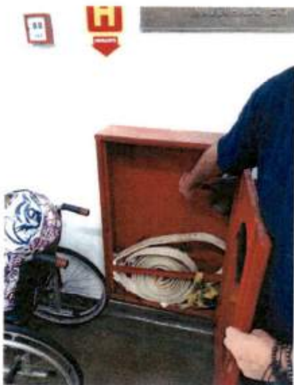
RECEPÇÃO – HIDRANTE H-3
