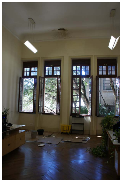
Queda do forro da sala 30 e infiltração na calha.
