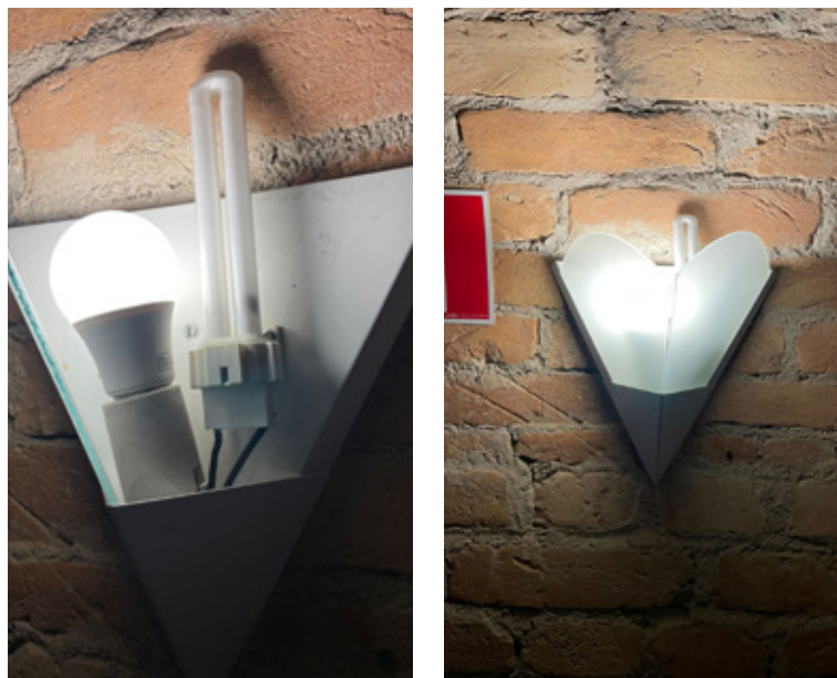
ERA - sistema de iluminação de emergência – subsolo (área do corredor).
