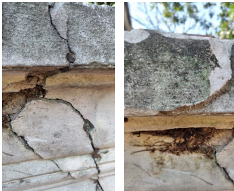
Situação da fachada leste – incrustação das raízes na platibanda.
