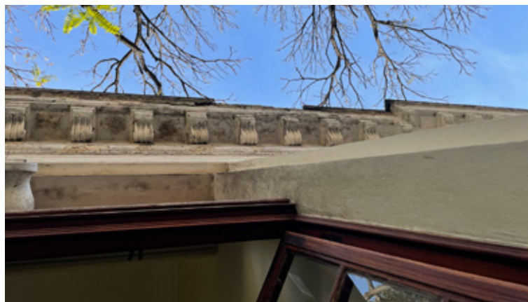
Área onde a platibanda foi retirada.
