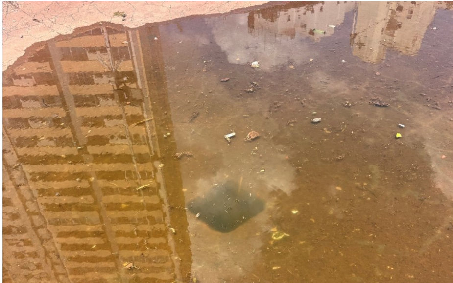
Figura 49 – Acúmulo de água no pavimento da praça
