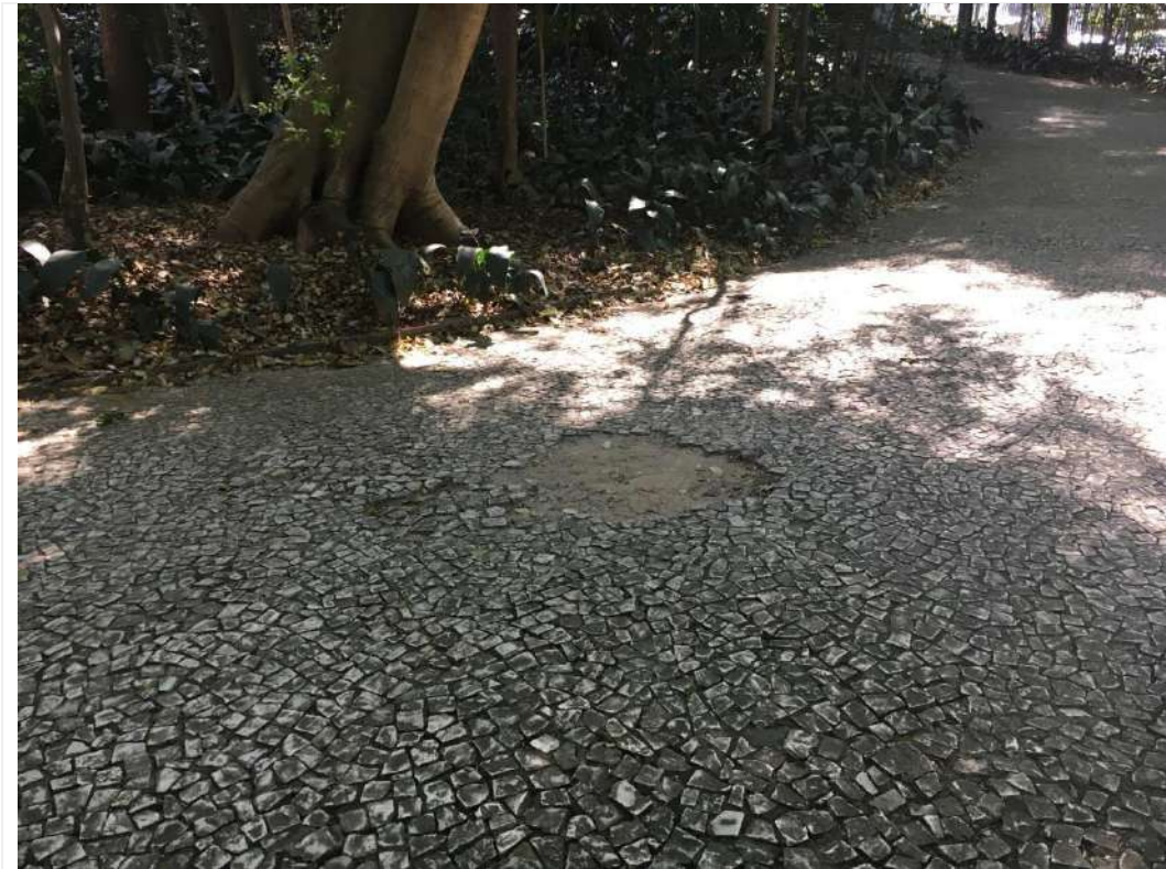
Estado de conservação dos pisos do Parque Trianon. Fonte: PMSP.
