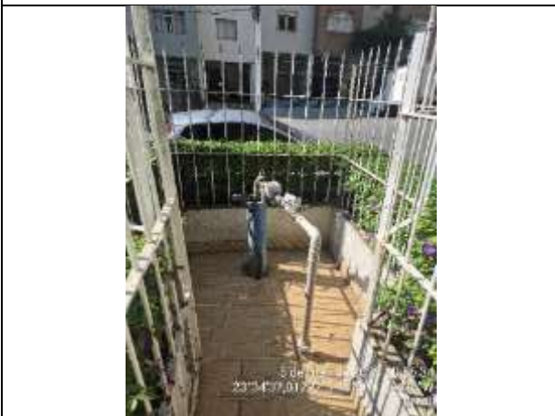
Hidrômetro no passeio da Avenida Armando Ferrentini
