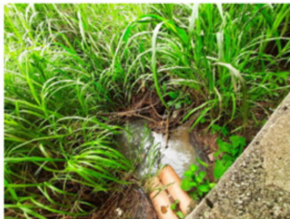
Foto IV.a.22 – Detalhe da tubulação lançando esgoto diretamente sobre o terreno aos fundos do núcleo. Fonte: COMDEC, vistoria em 29 de janeiro de 2024.
