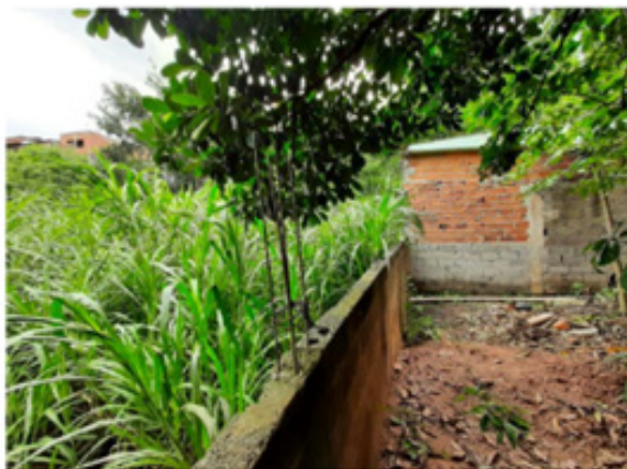
Foto IV.a.21 – Terreno aos fundos das moradias, ponto onde há lançamento de esgoto. Fonte: COMDEC, vistoria em 29 de janeiro de 2024.
