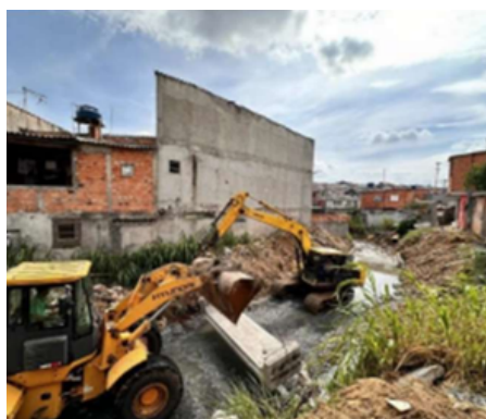
Figura 7 - Drenagem Córrego Lajeado (SUB-IT)
