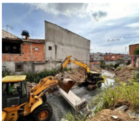
Figura 7 - Drenagem Córrego Lajeado (SUB-IT)
