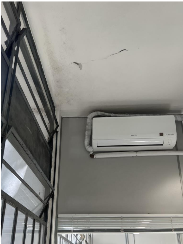
Forro da sala de reunião descascando e com trinca.
