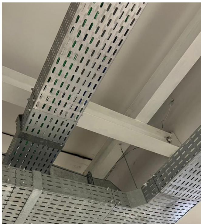
Forro de gesso cedendo e infiltração.
