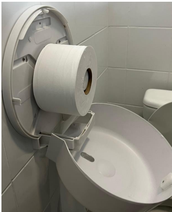
Papeleira do sanitário feminino quebrada.
