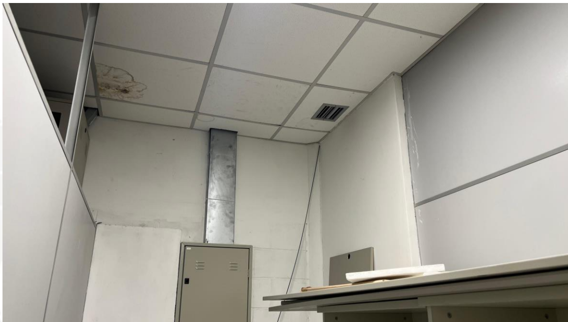
Infiltração no forro.
