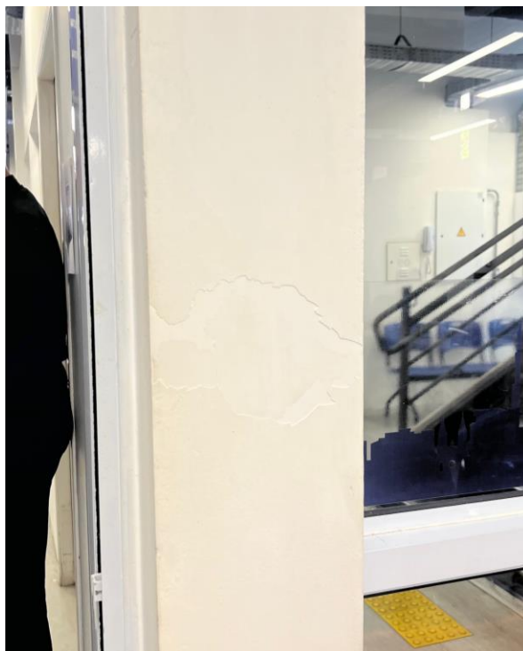
Pintura do pilar descascando.
