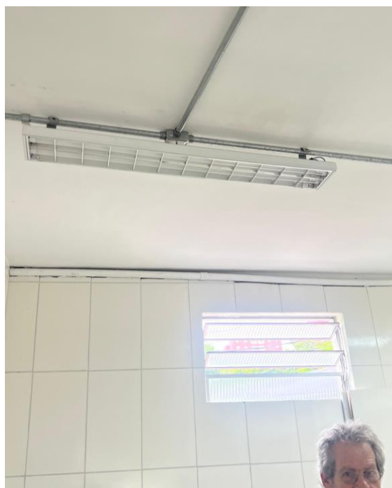
Luminárias queimadas no sanitário masculino.
