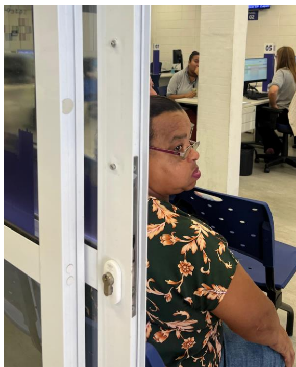
Maçaneta da porta de correr caiu.
