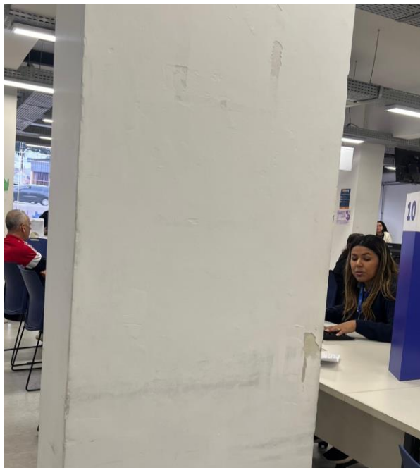
Pintura do pilar descascando.
