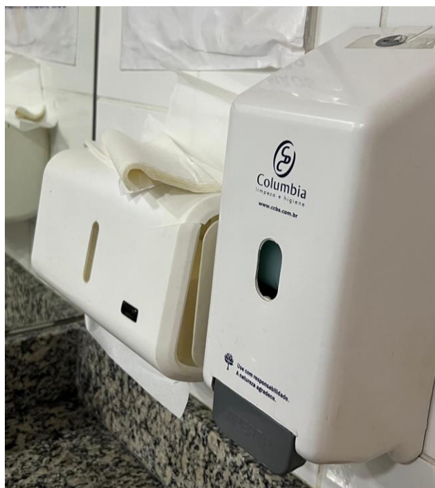
Papeleira quebrada no sanitário masculino.
