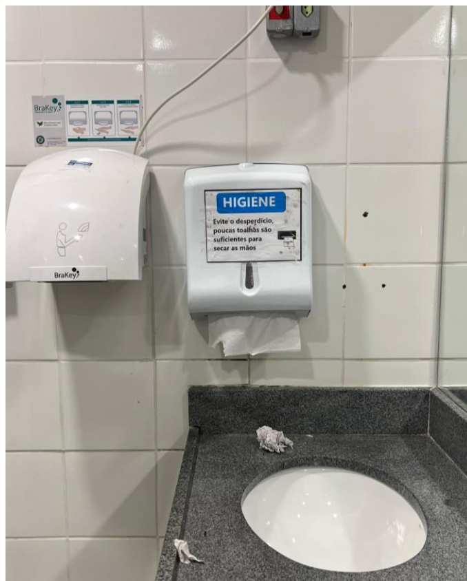
Sanitário masculino sem torneira e com secador de mão quebrado.
