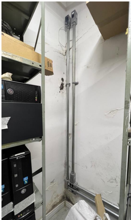
Parede com infiltração.
