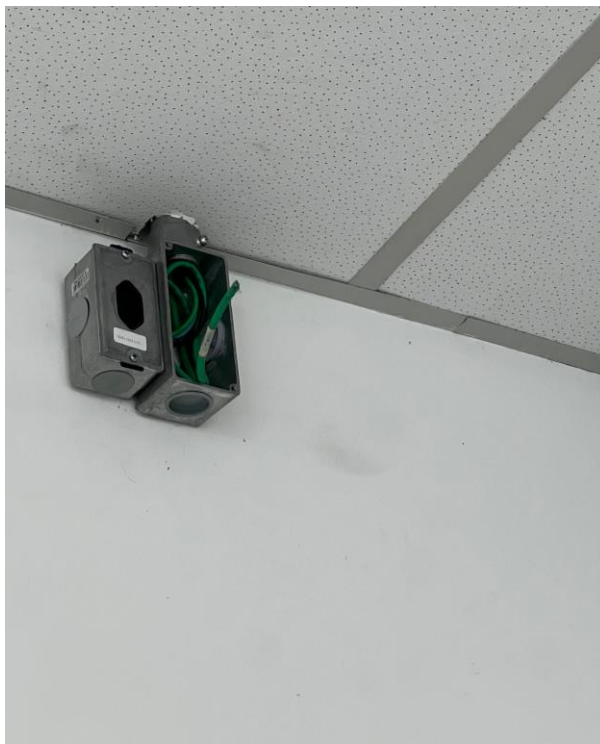
Caixinha de tomada com fios aparentes.
