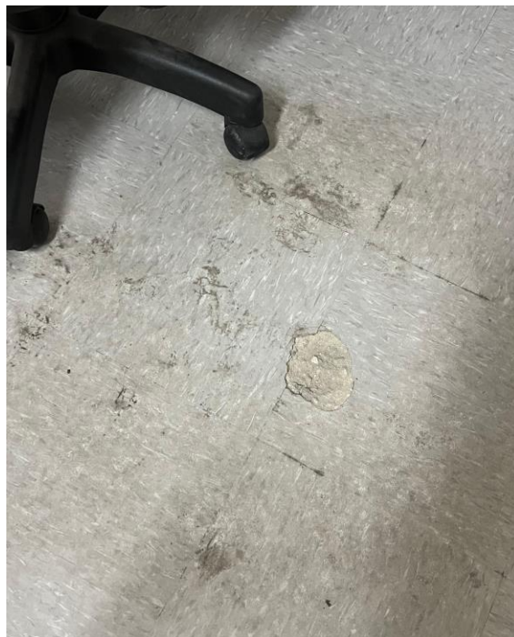
Buracos no piso.
