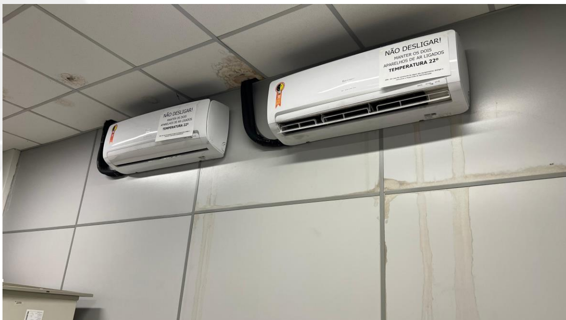
Infiltração no forro e parede divisória danificada pois os aparelhos de ar-condicionado vazam água.
