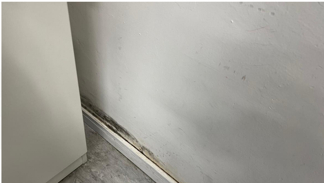
Infiltração na parede pela umidade do chão.
