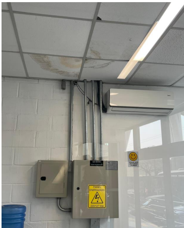
Infiltração no forro.
