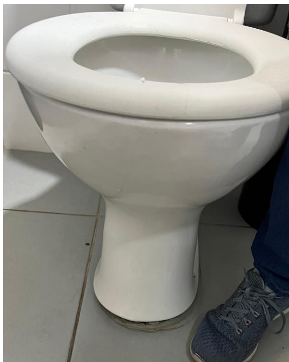
Bacia sanitária do banheiro feminino solta do chão.
