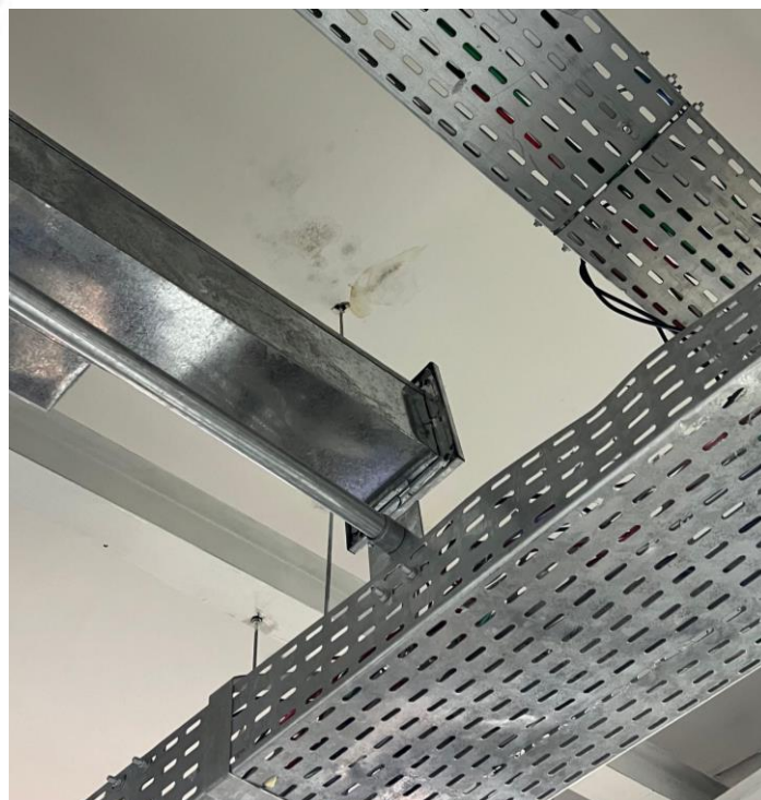
Forro com infiltração.
