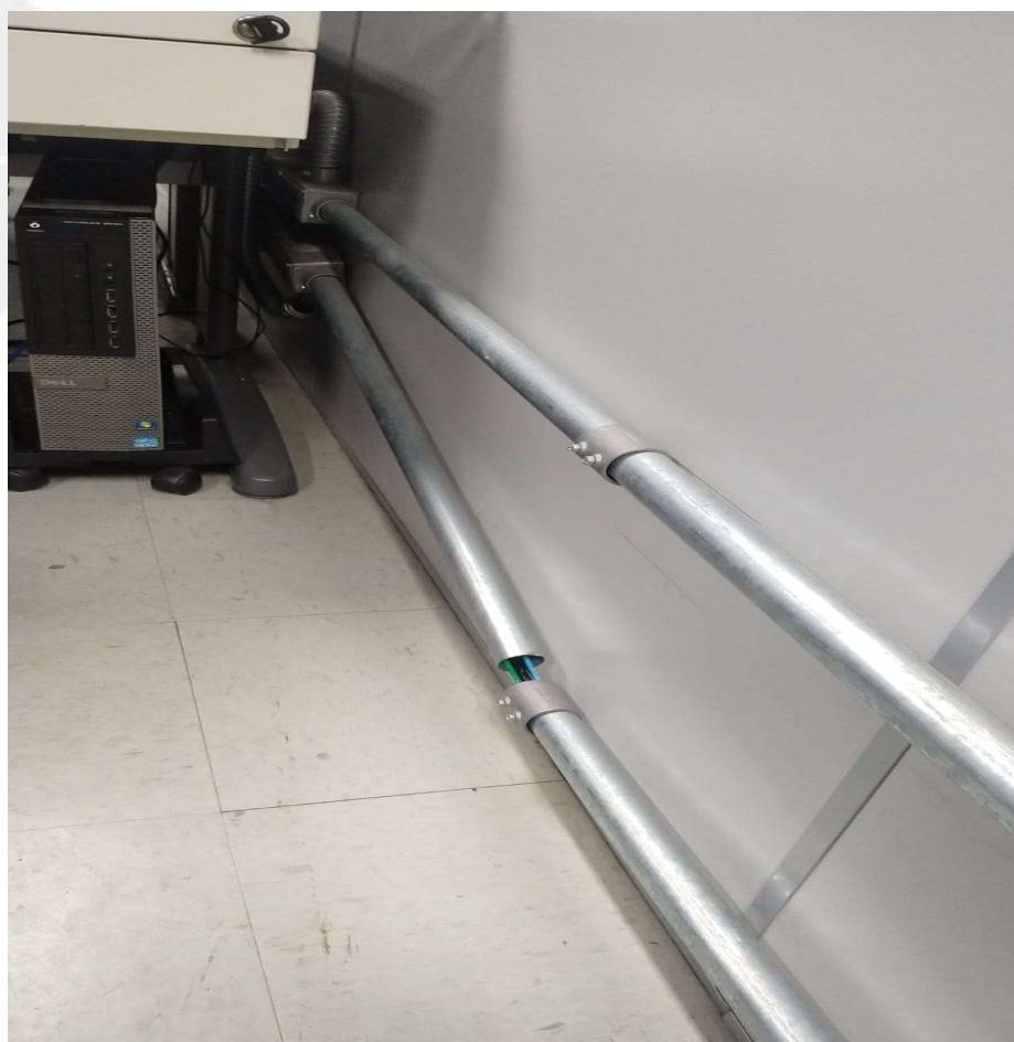
Eletrodutos se soltando das paredes e ficando pendurados
