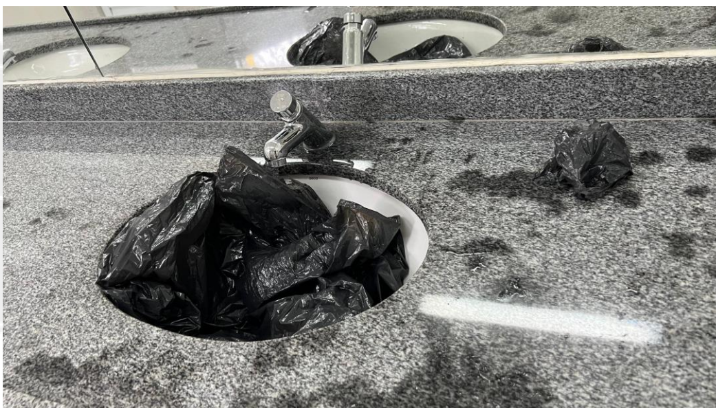
Pia com sifão quebrado no sanitário masculino.
