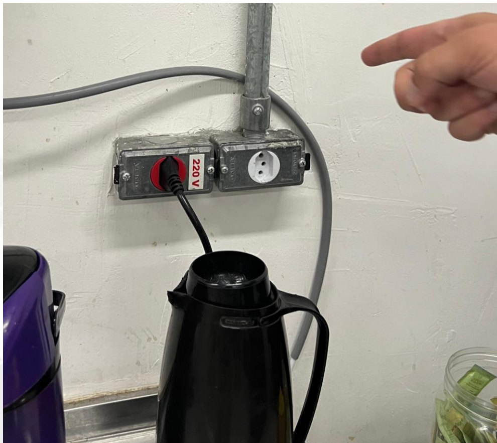
Tomada 110V não funciona.
