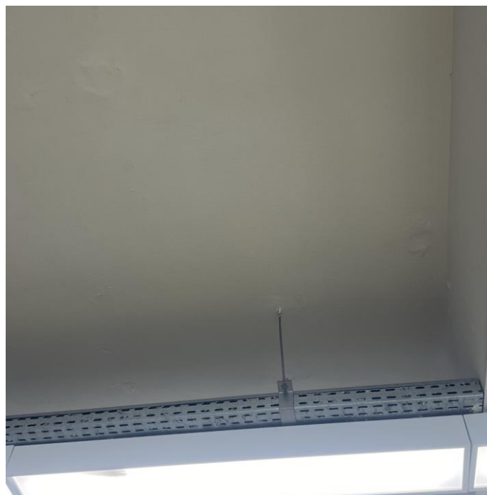
Infiltração no teto.
