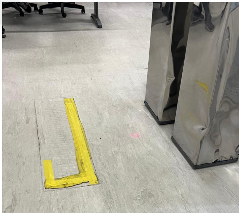
Piso afundado pela presença de ralo embaixo.
