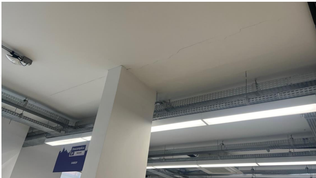
Trinca no teto, acabamento da junta de dilatação.
