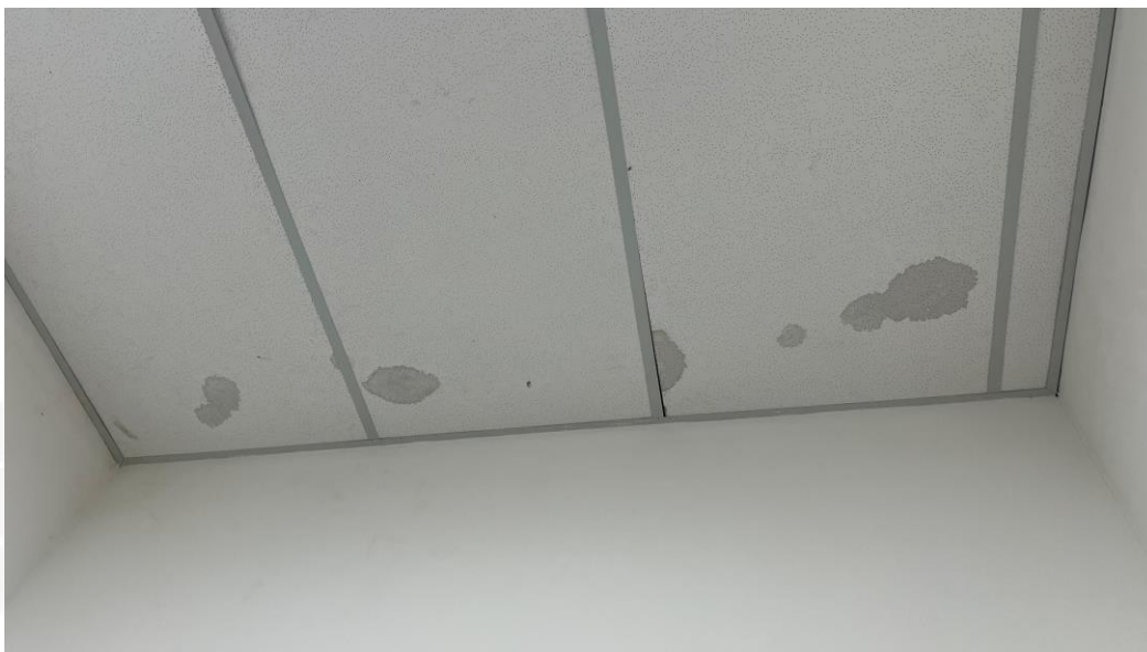
Infiltrações no forro da sala de reunião.
