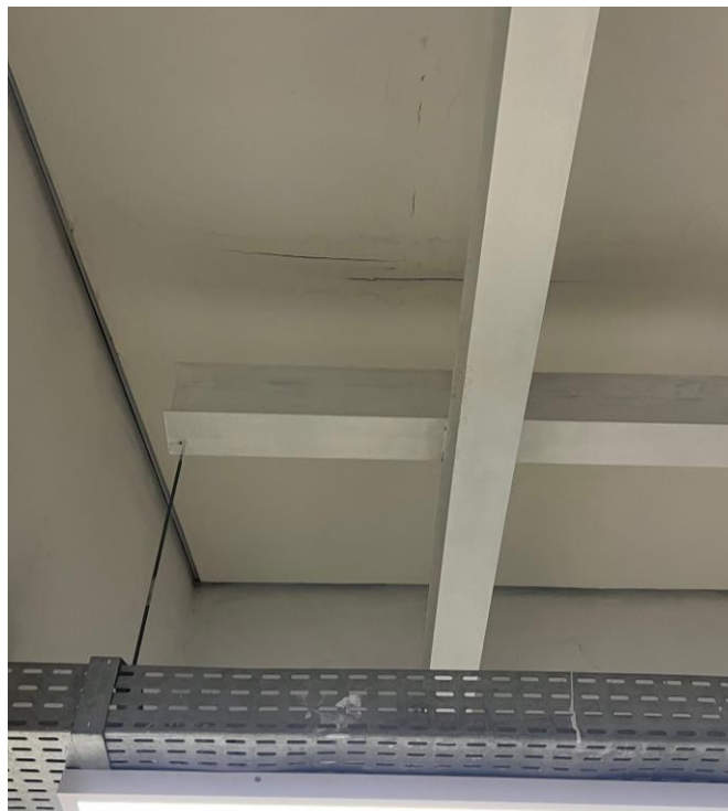
Forro de gesso rachado.
