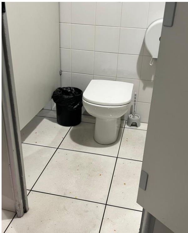
Cabine do sanitário masculino interditada. Bacia entupida.
