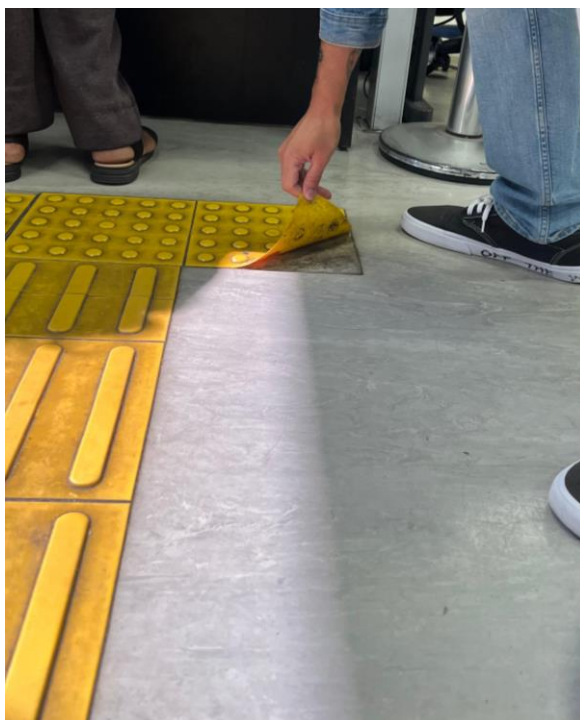
Piso tátil da recepção descolando.
