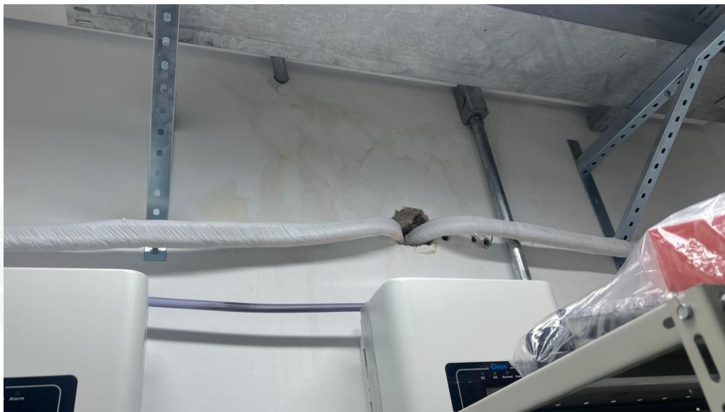
Infiltração na parede do CPD.
