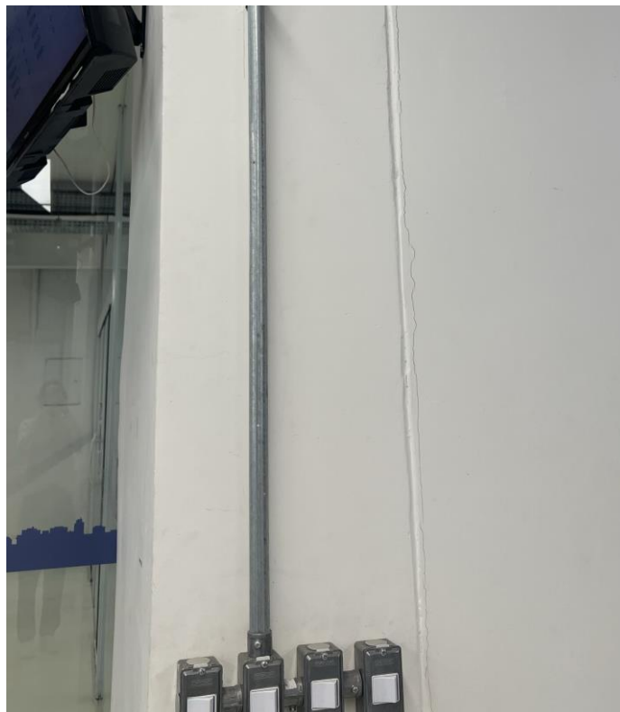
Trinca no pilar.
