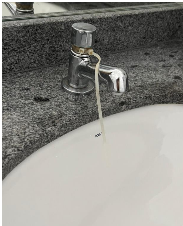
Torneira quebrada no sanitário feminino.
