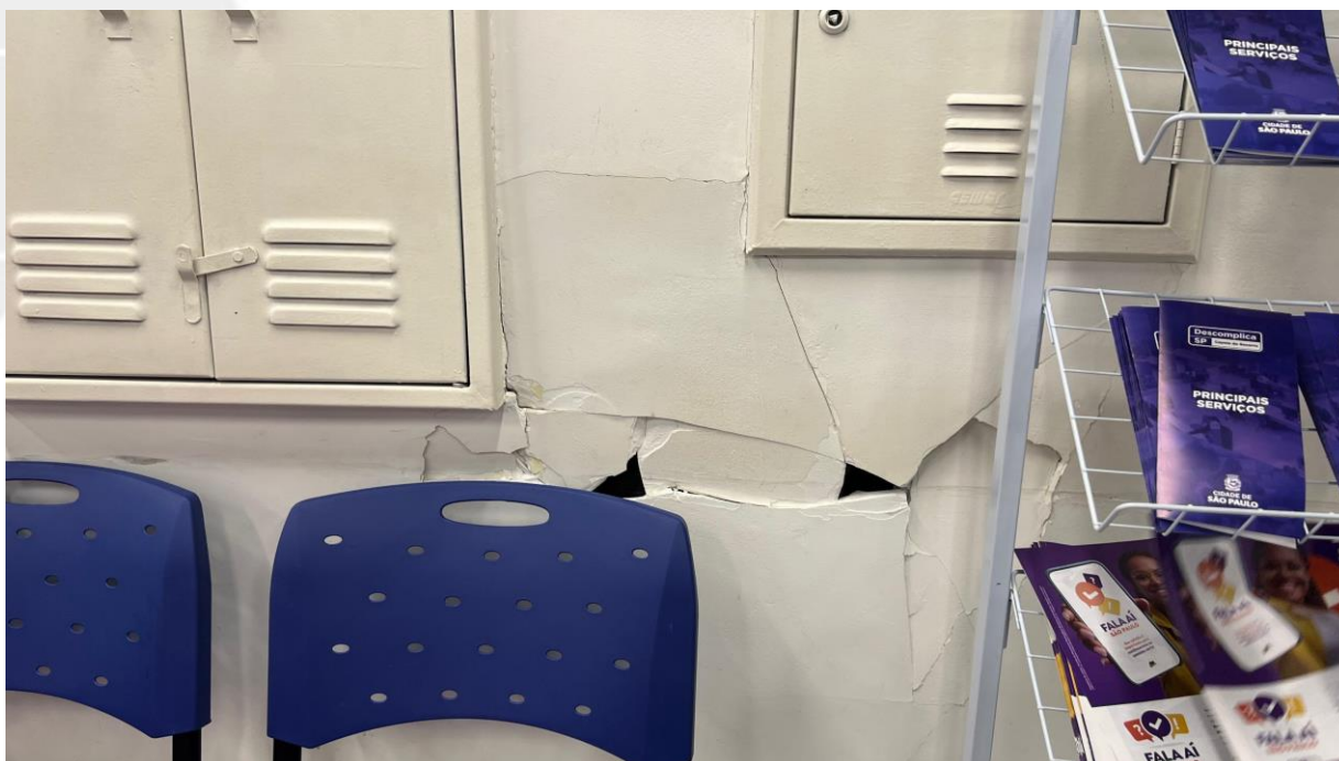
Buraco no drywall.
