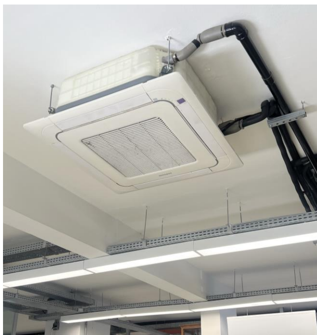
Nenhum ar-condicionado e exaustor funciona/liga, falta manutenção.
