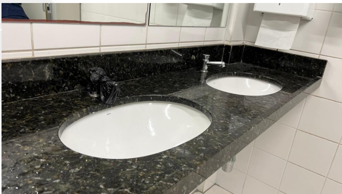
Torneira quebrada no sanitário feminino.
