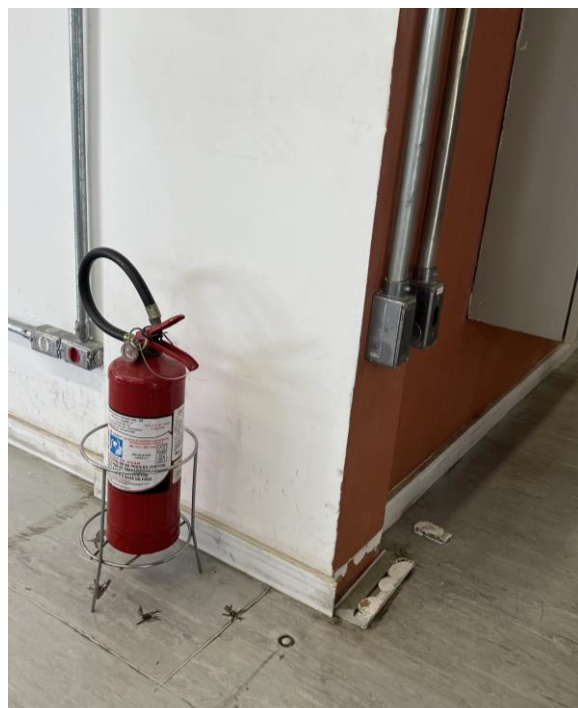
Extintore sem suporte, não pode estar apoiado no chão. Rodapé descolado.
