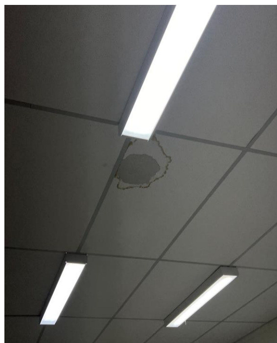
Infiltração no forro do sanitário feminino.
