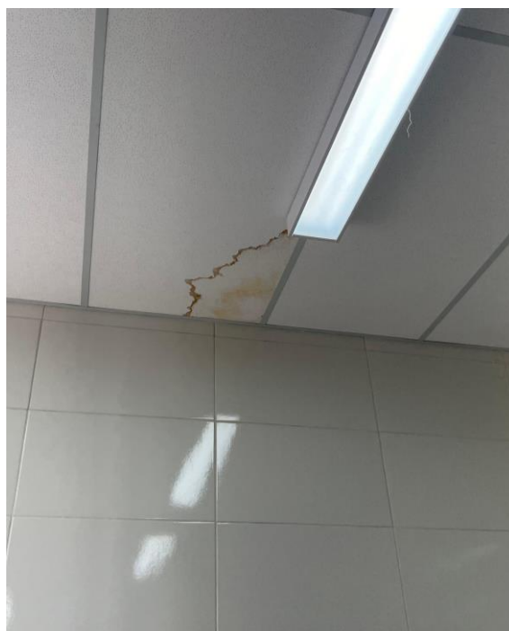
Infiltração no forro do sanitário masculino.
