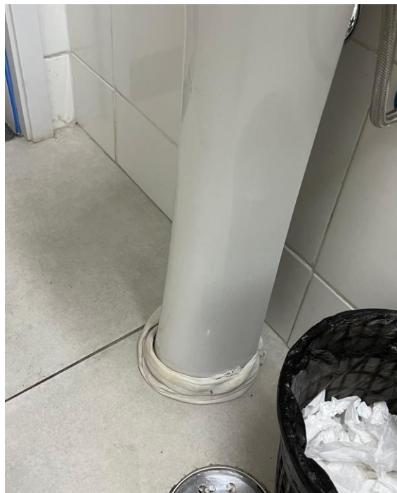
Pia com vazamento.
