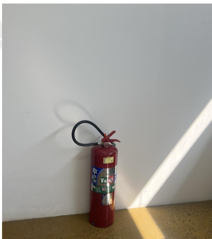
Extintor sem suporte na área de convivência, não pode estar apoiado no chão.
