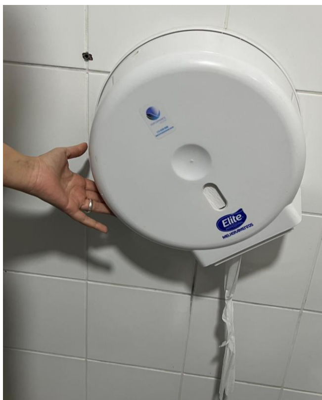
Maçaneta do sanitário feminino quebrada e papeleira solta.
