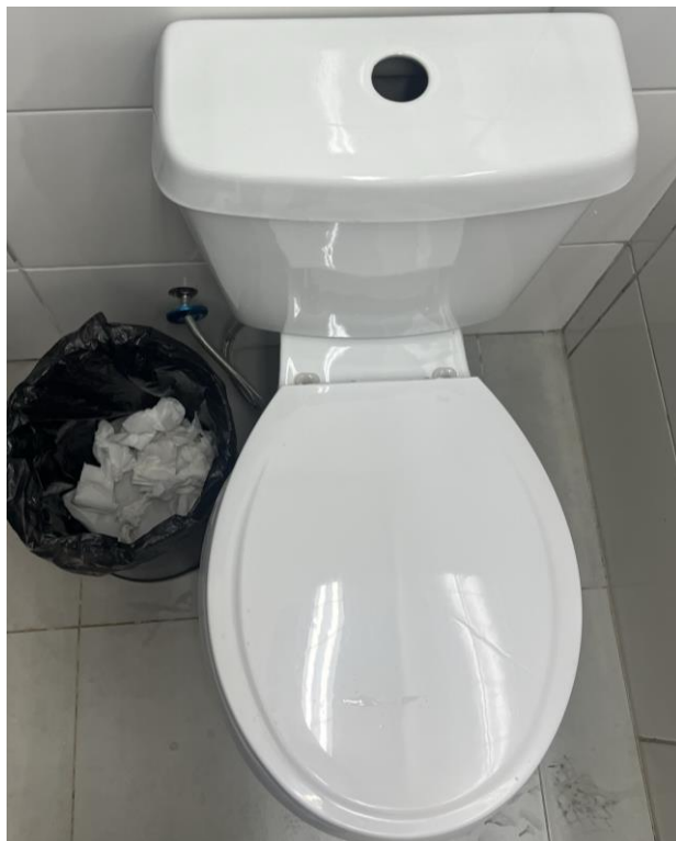
Bacia sanitária do banheiro masculino sem botão de descarga.
