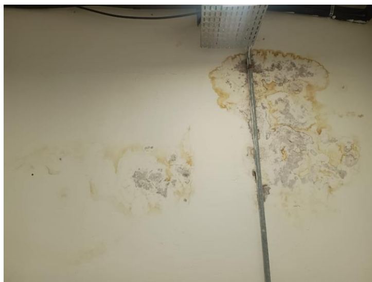
Parede com infiltração na sala de direitos humanos.
