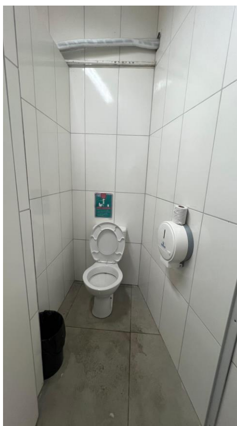
Infiltração pelo teto no sanitário feminino deixa chão da cabine molhado.
