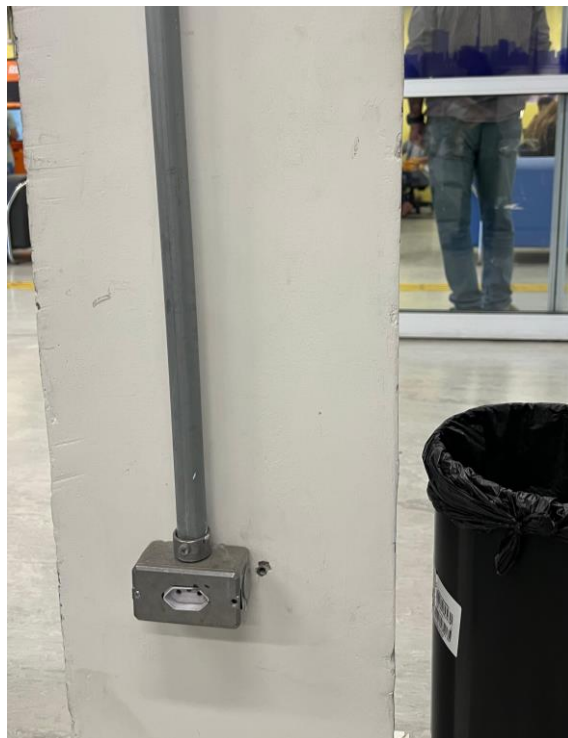
Tomada 110V não funciona.
