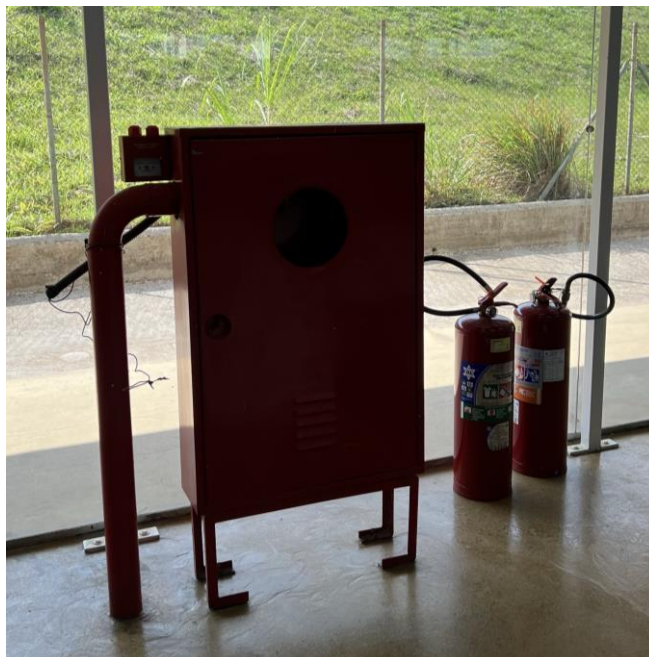
Hidrante sem instalações e equipamento interno (mangueira). Extintores sem suporte.
