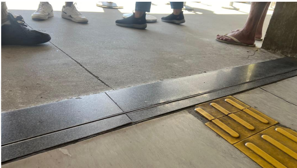
Trilho da porta amassado pela intensa circulação de pessoas.
