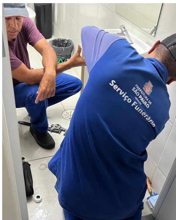
Pia com vazamento sendo arrumada por funcionários da subprefeitura.
