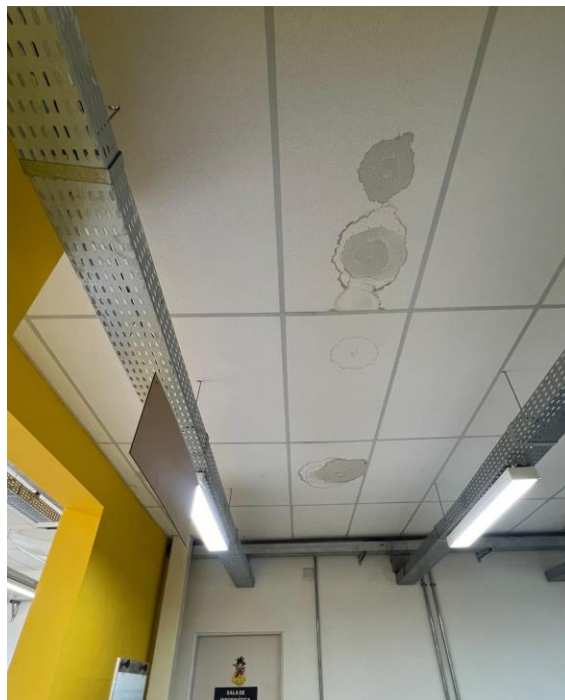
Pontos de infiltração no forro.
