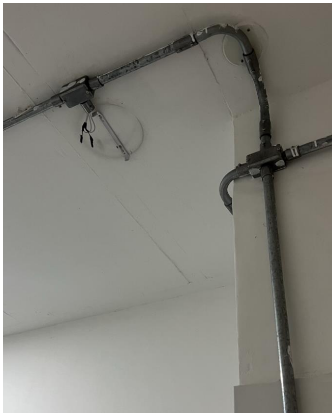
Sem luminária no sanitário feminino.
