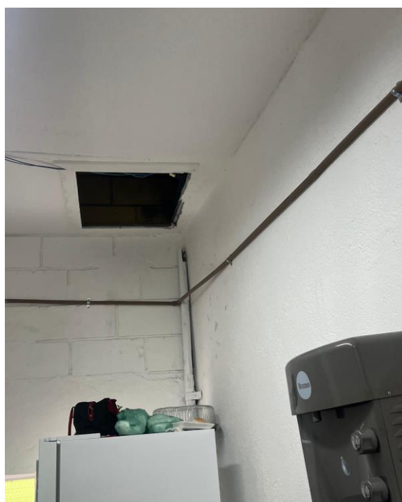
Alçapão aberto, pois, guarnições quebraram e não é possível encaixar a tampa.
