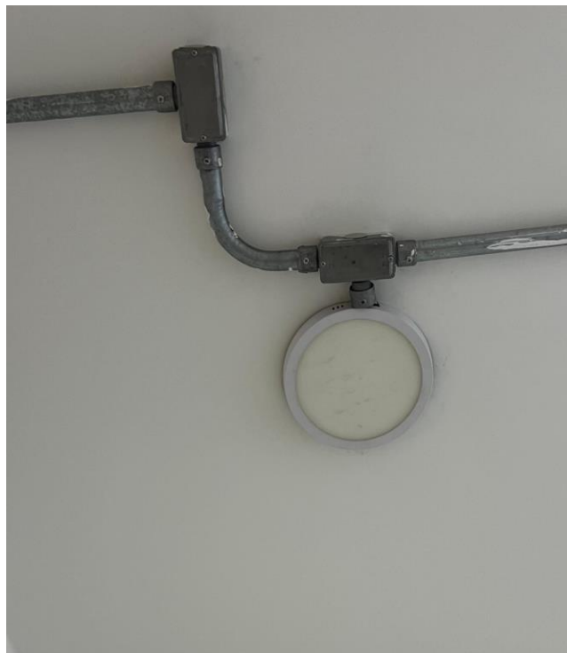
Luminária do sanitário feminino quebrada.
