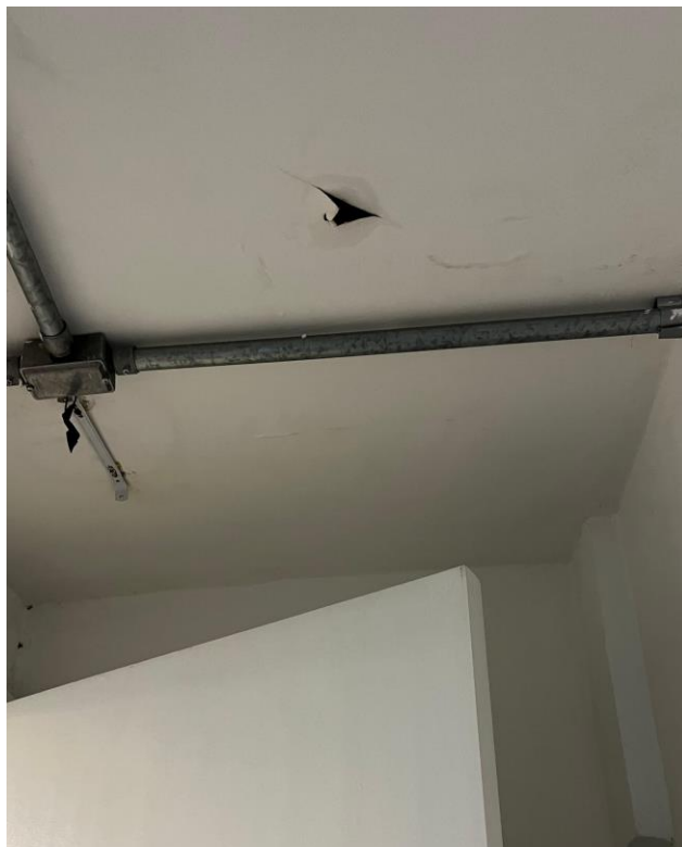
Forro furado e eletroduto com fio para fora.
