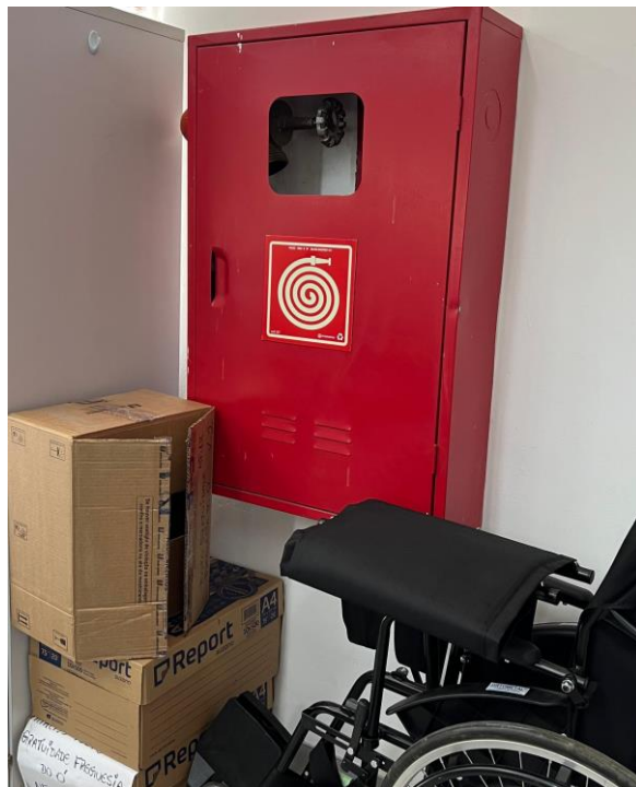
Objetos obstruindo hidrante.
