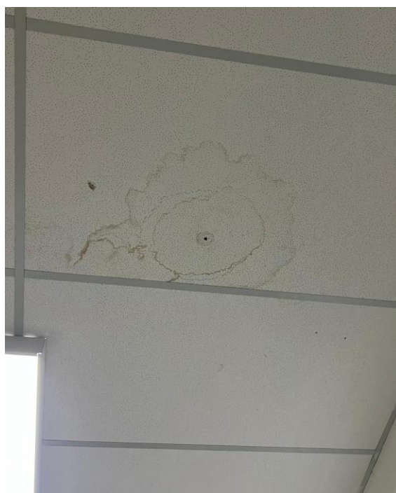
Infiltração causou buraco no forro da área de convivência.
