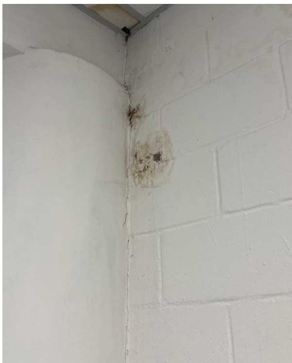
Infiltração na parede do miniauditório.
