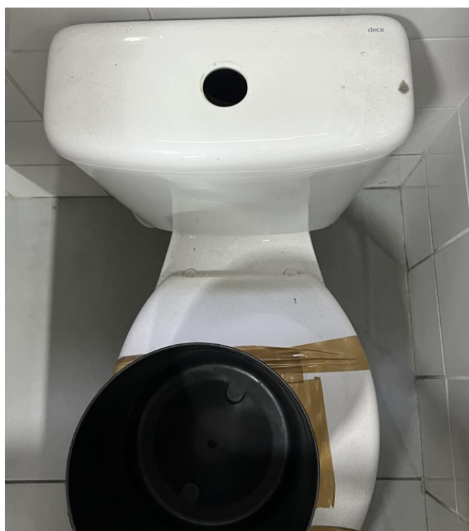
Banheiro interditado, não tem descarga.
