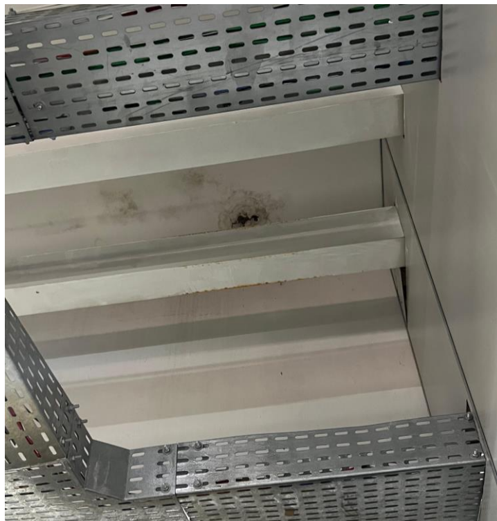
Forro com buraco causado pela infiltração.
