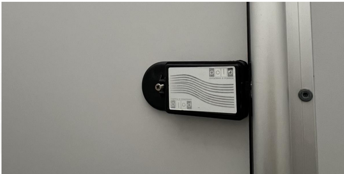
Maçaneta do banheiro feminino quebrada.
