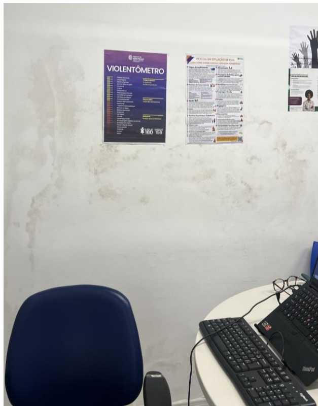
Infiltração na parede da sala de direitos humanos.
