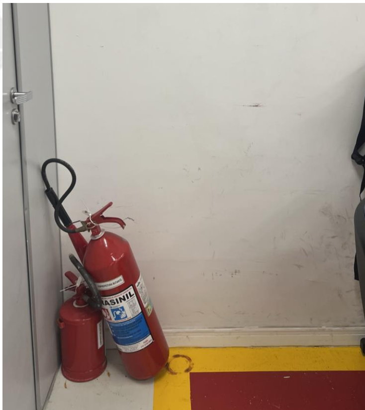
Extintor sem suporte, não pode estar apoiado no chão.
