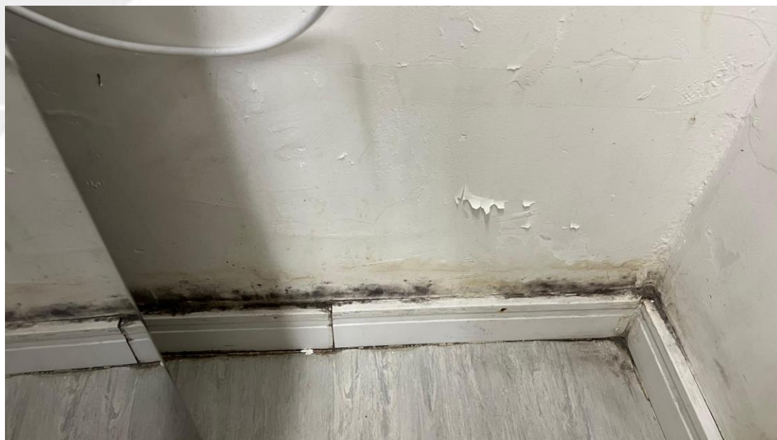
Infiltração na parede pela instalação do bebedouro.
