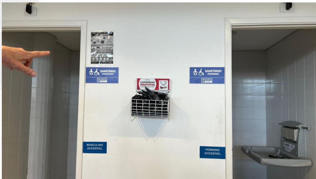
Retirar placas de porta com diferenciação entre feminino e masculino nos sanitários acessíveis.
