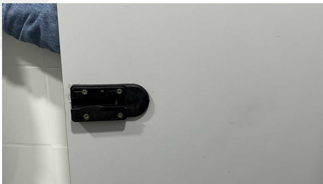
Maçaneta do banheiro feminino quebrada.
