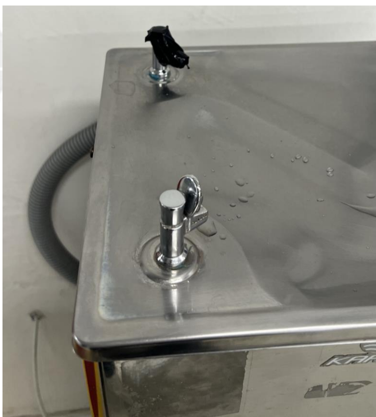
Bebedouro com torneira quebrada.
