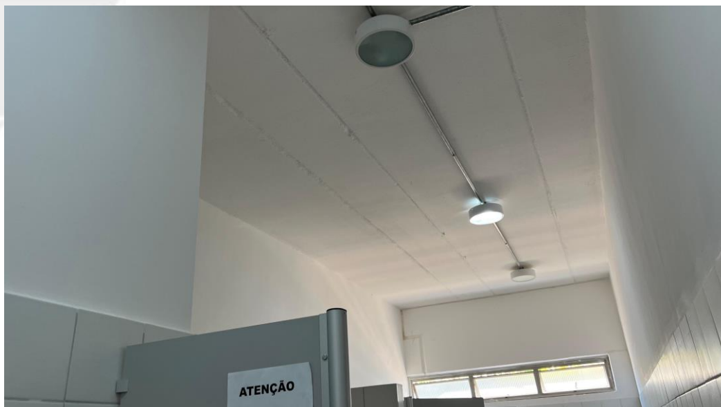
Luminária quebrada no sanitário feminino.
