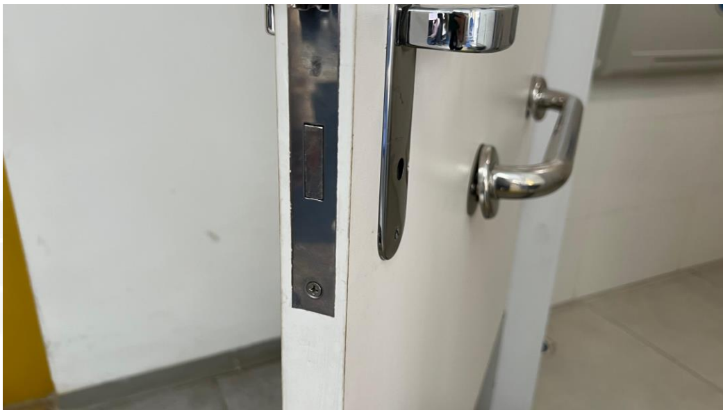
Sem chave na porta no sanitário PCD.
