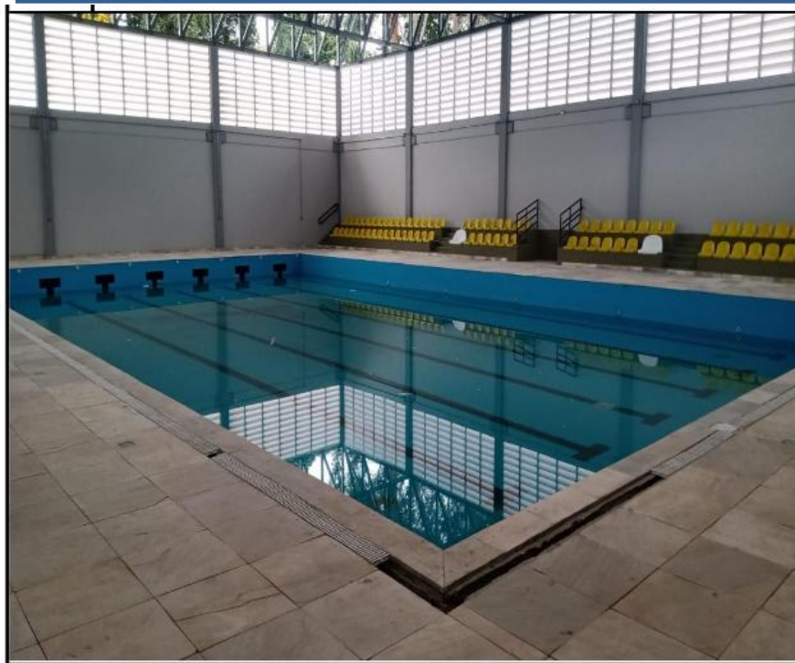
GINÁSIO PISCINA SEMI OLIMPICA COM REVESTIMENTO DE PISO, RALO SECA PISO, PINTURA, ASSENTOS.
