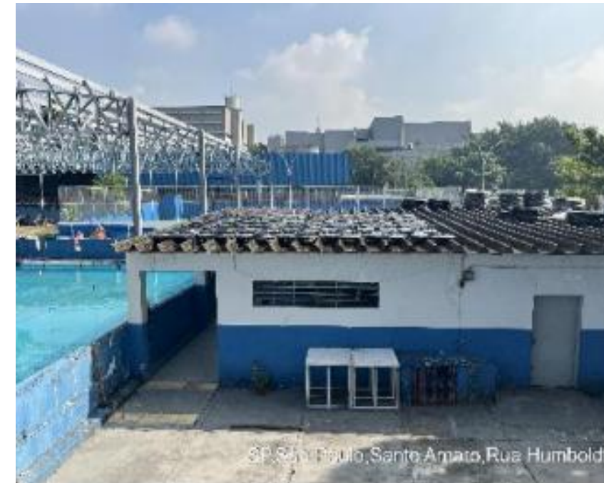
PISCINA SEMI OLÍMPICA – AQUECIMENTO
