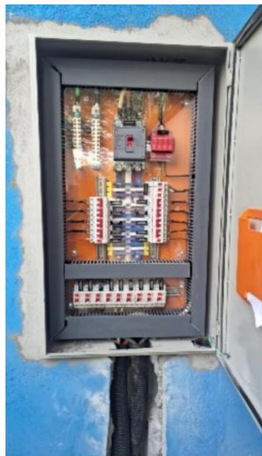
FOTO 68 – ILUMINAÇÃO EXTERNA I
