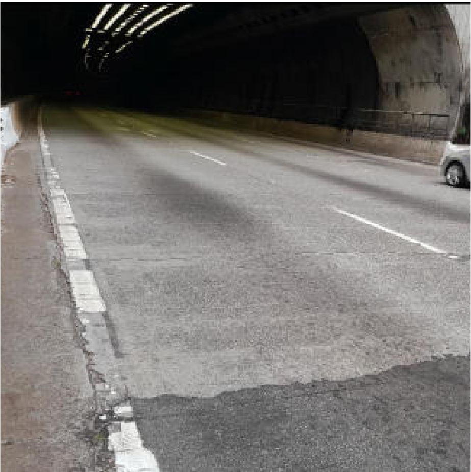
Identificação de Patologia
