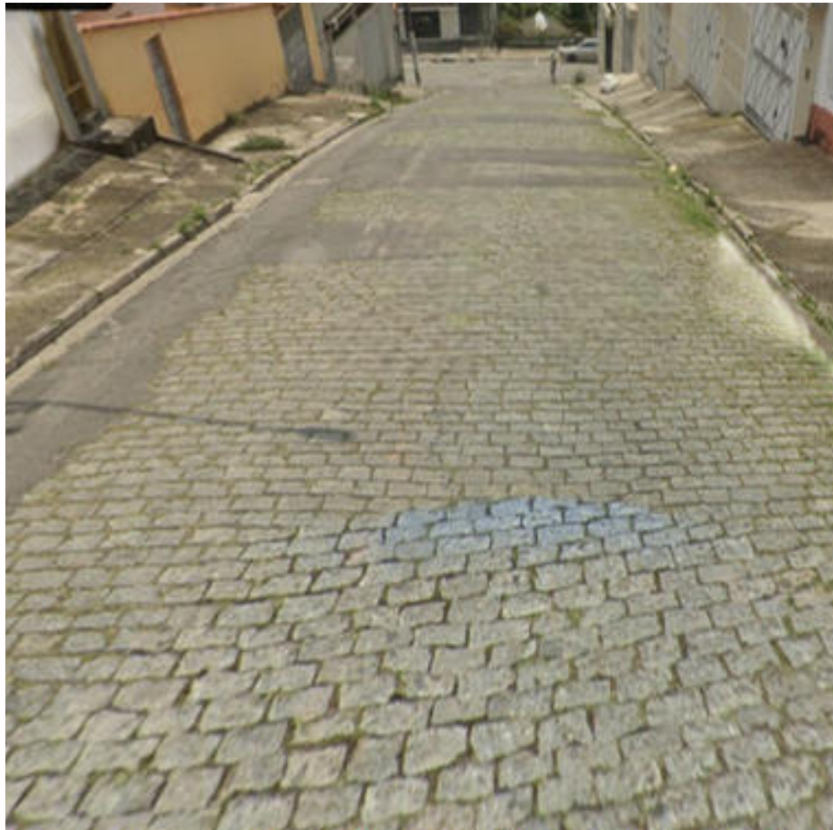
Identificação de Patologia
