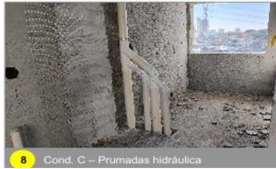
8 Cond. C – Prumadas hidráulica
