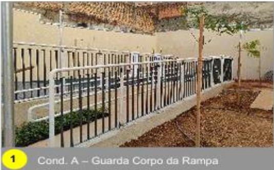
1 Cond. A – Guarda Corpo da Rampa
