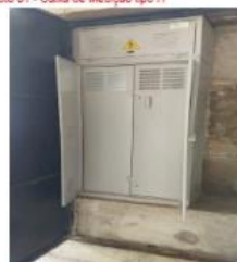
Foto 03 - Caixa de Medição tipo H
