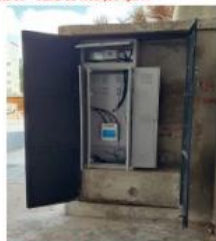
Foto 05 - Caixa de Medição tipo H
