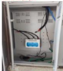
Foto 06 - Caixa de Medição tipo H
