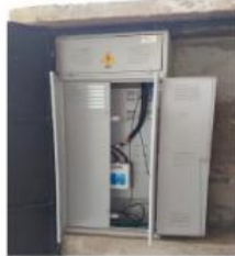
Foto 04 - Caixa de Medição tipo H
