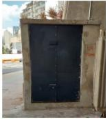
Foto 01 - Caixa de Medição tipo H
