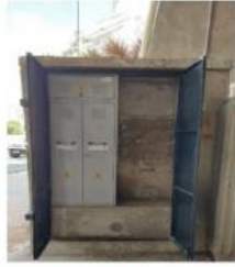
Foto 02 - Caixa de Medição tipo H
