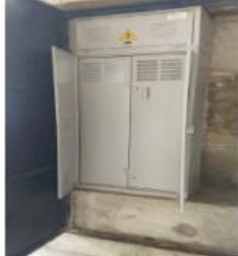
Foto 03 - Caixa de Medição tipo H
