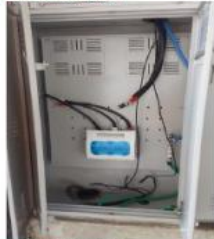
Foto 06 - Caixa de Medição tipo H
