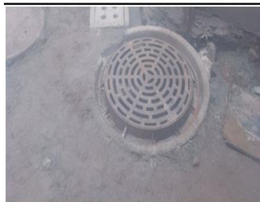
Grelha de captação pluvial
