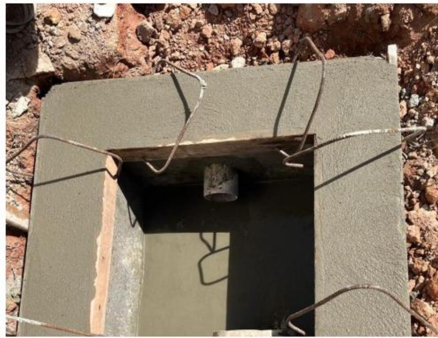
CAIXA DE INSPEÇÃO
