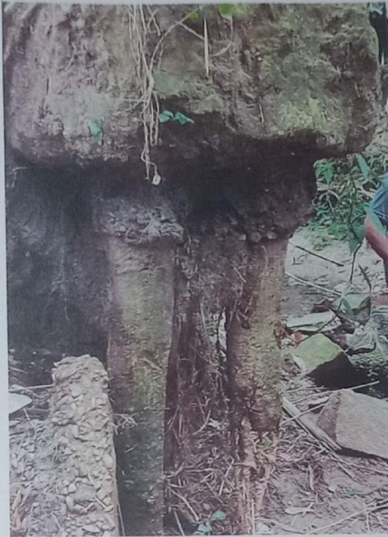
Foto 1- Base sustentação margem direita
