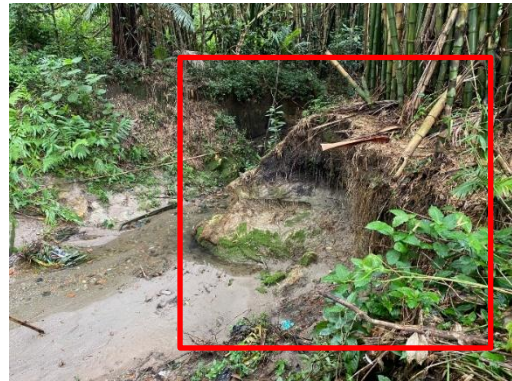
Imagem 4: Bico do talude a ser “cortado” para que a água não fique voltando e criando um vórtice, com isso serão diminuídas as chances de novas erosões aparecerem (Item a ser realizado pela contratada de SIURB).
