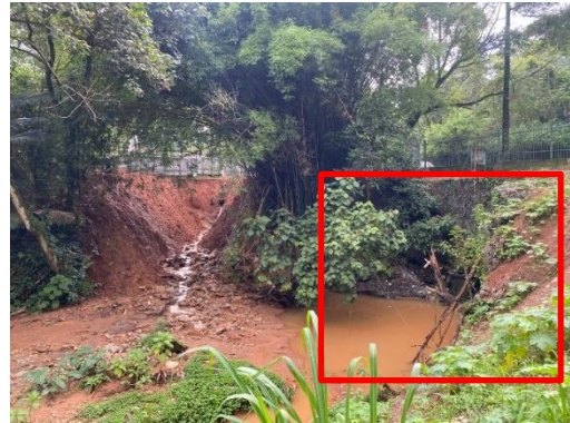
Imagem 2: Local afetado pela erosão acima da galeria (Item em replanilhamento pela empresa contratada por SIURB para resolução do caso).
