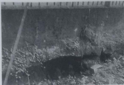
Agravamento do solapamento próximo da calçada R. Bernardino
