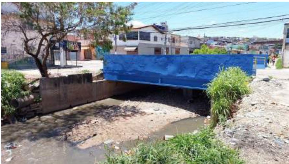
Foto 39 - Resíduos depositados no leito do córrego. Fonte: Centro Ambiental, 2024
