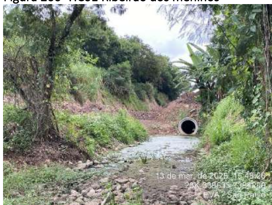
Figura 202- HC02 Captação de águas pluviais
