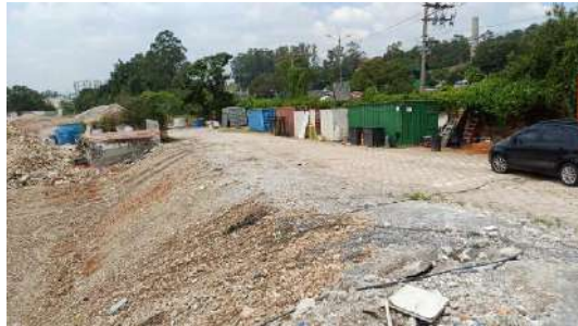
Figura 106- GEM8 - Talude no acesso principal, indicando desnível por corte e aterro.
