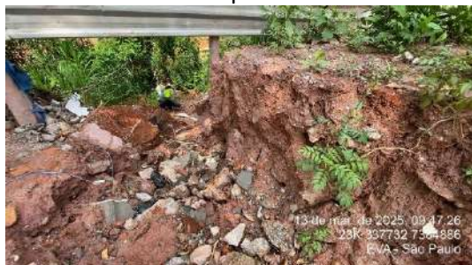
Figura 135- PED03 - Perfil erosivo com blocos rochosos dispersos na base do talude, além de diversos detritos oriundos de ação antrópica.
