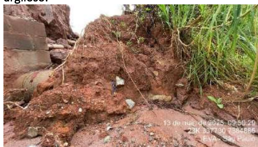
Figura 140- PED04 – Detalhe do recorte erodido do talude
