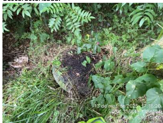
Figura 189- HAlI15 Tubulação de água pluvial
