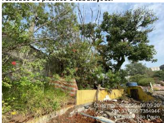
Figura 123- PED01B - Resíduos de ação antrópica – resíduos de demolição.
