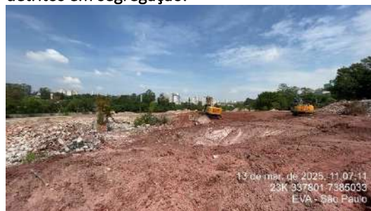
Figura 294- US14 - Situação atual da área em processo de demolição, com solo exposto e máquinas trabalhando.
