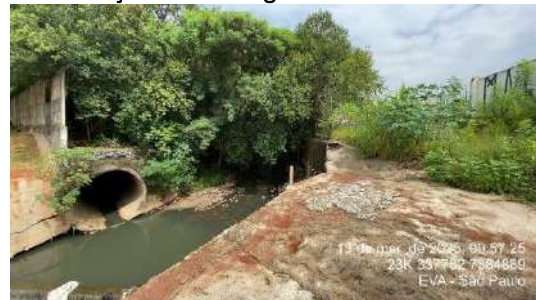
Figura 225- H09 - Tubulação pluvial
