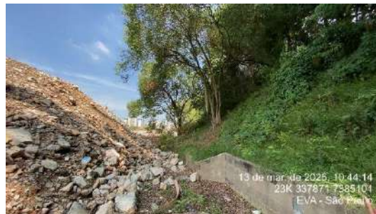
Figura 91- GEM03 - Talude íngreme em corte antrópico, com acúmulo de entulho e blocos de concreto
