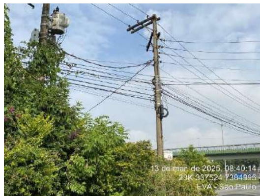
Figura 290- US10 - Rede elétrica de baixa e alta tensão no acesso ao empreendimento.
