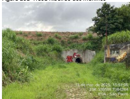
Figura 203- HC03 Captação de águas pluviais
