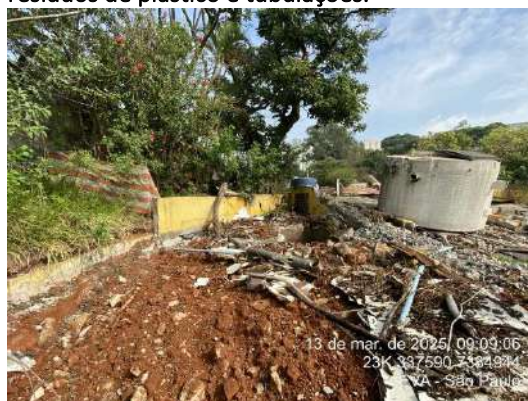
Figura 124- PED01B – Resíduos de ação antrópica – resíduos de demolição.
