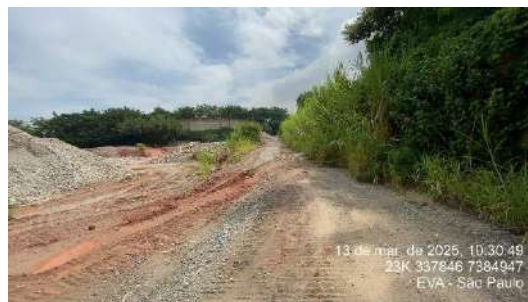
Figura 115- GEM 11 - Visada a partir da porção mais baixa, sendo possível observar a cota mais alta do terreno, na base do muro.
