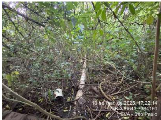
Figura 196- HAl17 Tubulação parcialmente soterrada.
