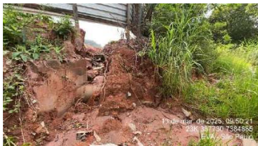
Figura 141- PED04 - Erosão junto à tubulação na borda da ADA com exposição de solo.
