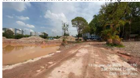
Figura 113- GEM 10 - Área rebaixada com acúmulo de água pluvial.
