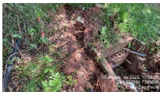
Figura 89- GEM02 Corte exposto com vegetação rala e presença de erosão
