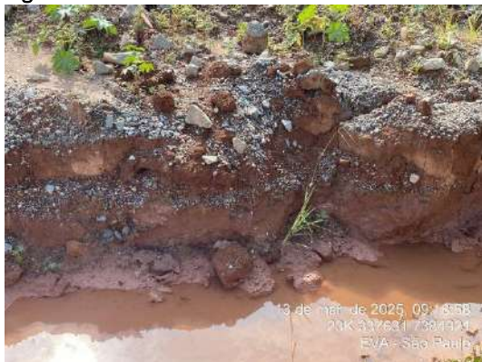
Figura 208- H03 - Exposição de Linha de Pedras devido à escavação provisória de rede de drenagem
