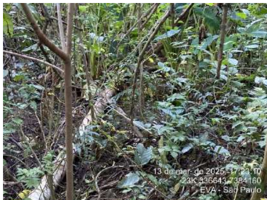
Figura 194- HAI17 Tubulação parcialmente soterrada.
