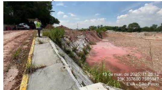
Figura 101- GEM06 - Talude com acúmulo de água na base
