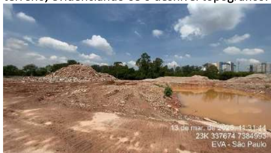
Figura 112- GEM 10 - Área rebaixada com acúmulo de água pluvial.
