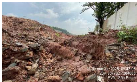
Figura 132- PED03 – Horizonte B latossólico exposto com coloração vermelho-escura. Diversos fragmentos de rocha próximos ao muro (limite da ADA).
