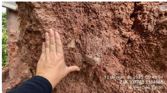
Figura 133- PED03 - Detalhe da estrutura granular em solo laterítico intemperizado
