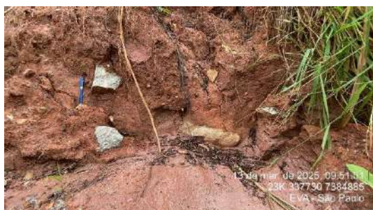
Figura 139- PED04 – Aterro com matriz argilosa, onde se encontra o matacão e blocos angulosos
