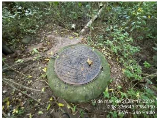
Figura 197- HAl17 Desemboque em tubulação da galeria de águas pluviais.
