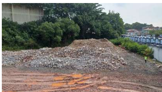
Figura 88- GEM01 [-23.637077, 46.589663] Borda da ADA com entulho, solo retificado
