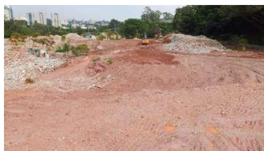
Figura 87- GEM01 [-23.637135, 46.589673] - Área rebaixada por terraplenagem, com cobertura de entulho e solo exposto
