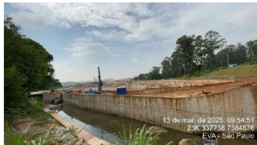
Figura 274- US02 - Canal de conexão do Córrego Jaboticabal ao piscinão lindeiro.
