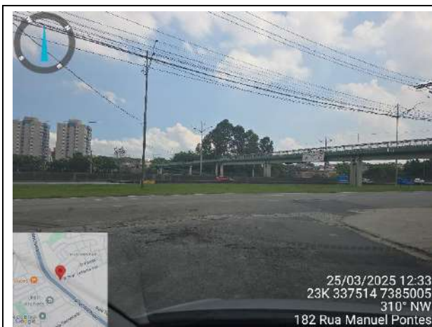
Foto 3.1.9. | Saída da Rua Prof. Zeferino Vaz para a Marginal da SP-150 - Via Anchieta. A imagem mostra a existência de pequenos defeitos no pavimento da via.
