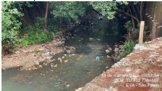
Figura 224- H09 - Córrego com acúmulo de detritos
