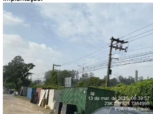
Figura 288- US10 - Estruturas provisórias de apoio às atividades de demolição. Notar rede elétrica margeando o empreendimento.
