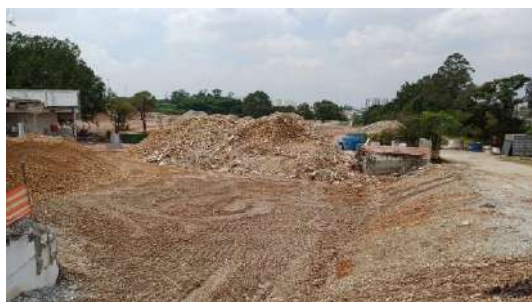
Figura 104- GEM 8 - Entulhos acumulados na ADA
