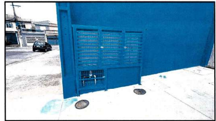
FOTO 6 – Entrada de energia
