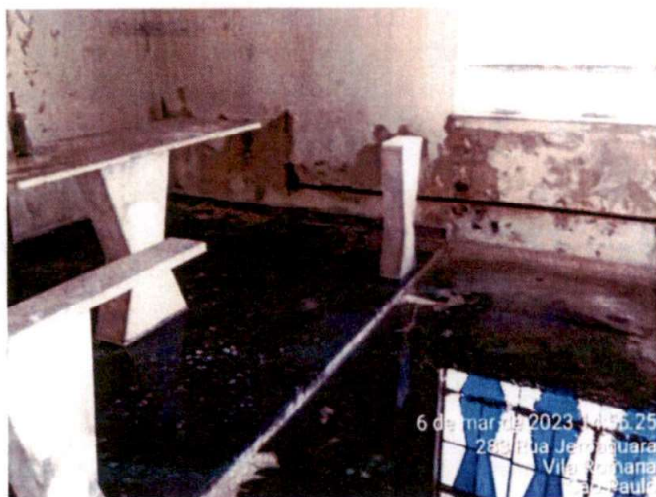
Foto 6 – Poças d'água existentes no 6º pavimento
