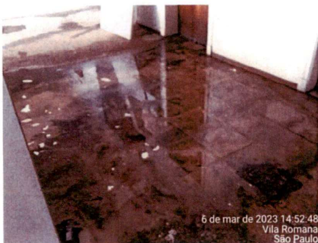
Foto 5 – Poças d'água existentes no 6º pavimento
