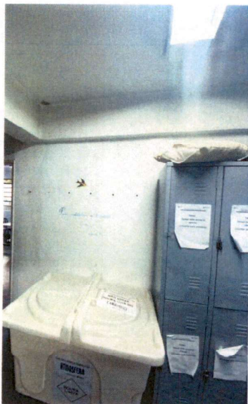
CORREDOR REFEITÓRIO - HIDRANTE H-4.
