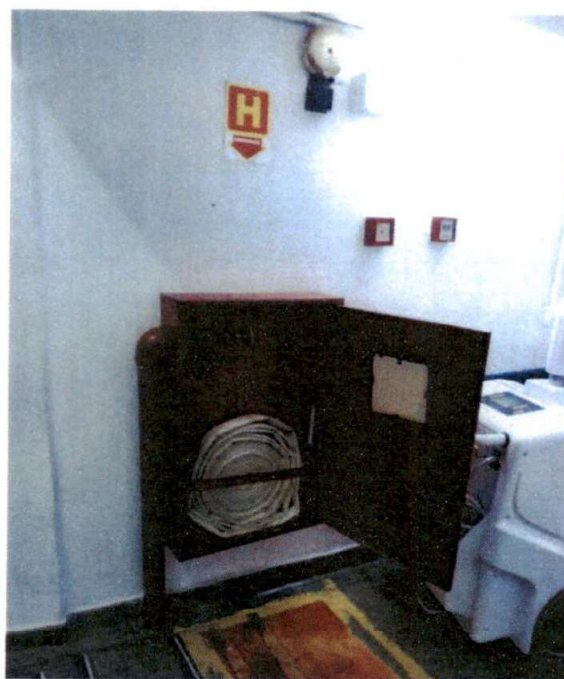
CORREDOR PRINCIPAL – HIDRANTE H-2.
