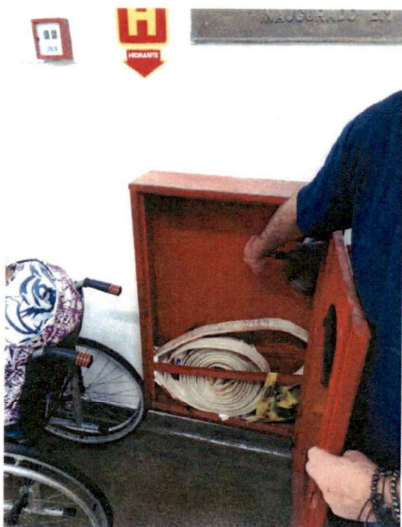
RECEPÇÃO – HIDRANTE H-3
