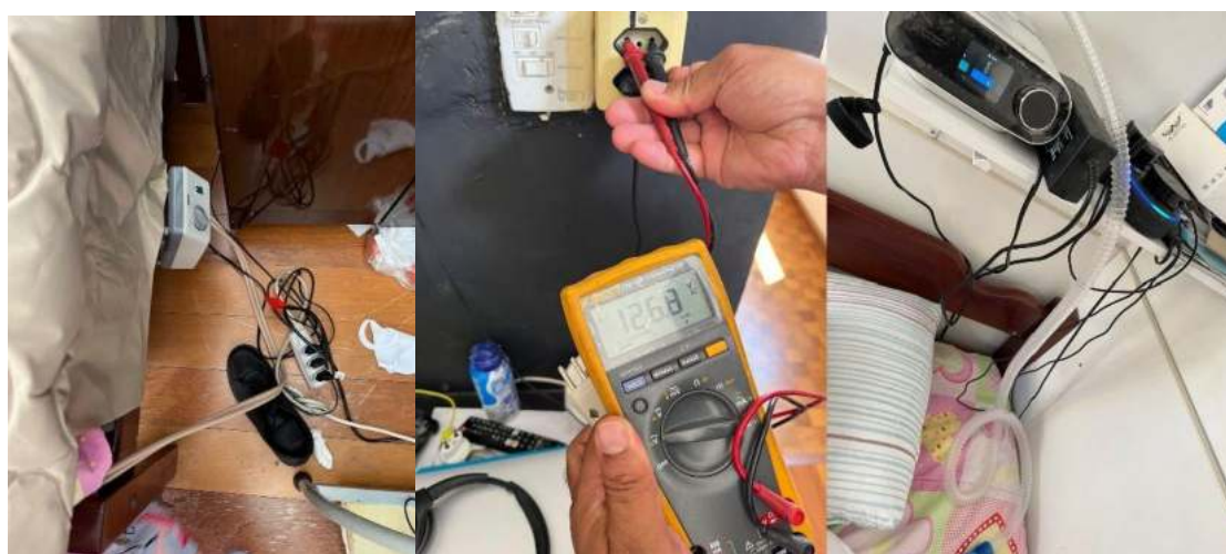
Figura 8 – Caminho percorrido para alimentação elétrica – tomada longe da cabeceira do leito
