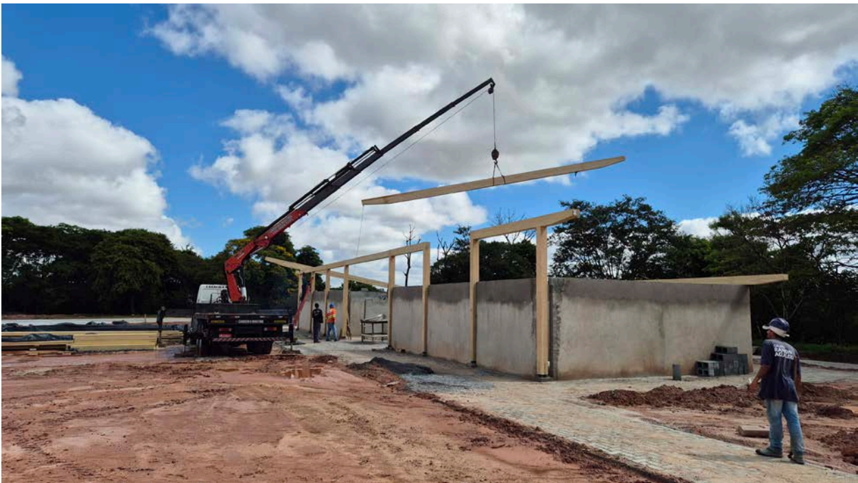
Figura 22 - Núcleo esportivo em obras: montagem da estrutura em MLC para os vestiários.
