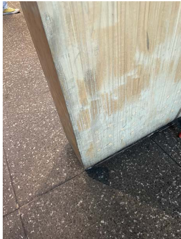
Figura 58 - Processo de degradação da madeira devido à exposição contínua.
