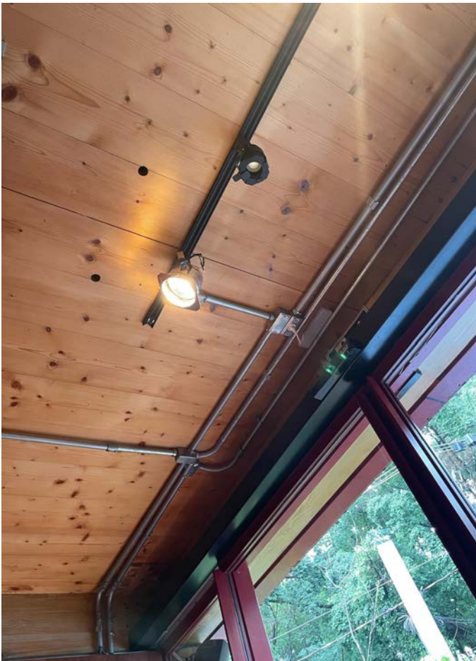
Figuras 51-52 - Tetos com soluções distintas: cobertura com fechamento translúcido e iluminação zenital, e forro em madeira com iluminação artificial aparente e instalações expostas.
