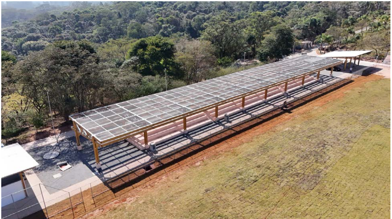
Figura 14 - Parque do Carmo, obra viabilizada pela SVMA. Núcleo esportivo em obras: cobertura em MLC para a arquibancada.
