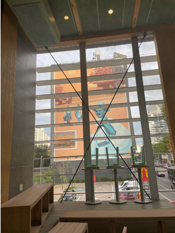
Figura 59 - Sistema de contraventamento com cabos de aço fixados à estrutura.
