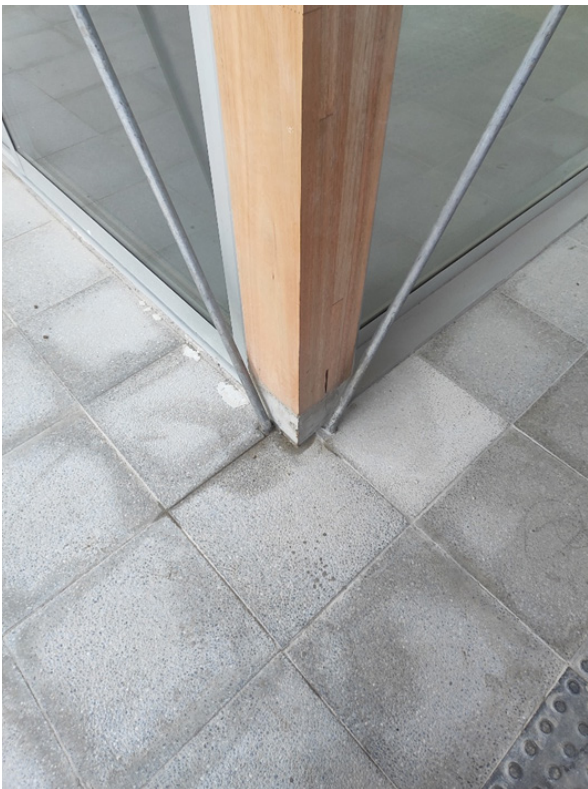
Figura 35 - Sistema de contraventamento com cabos de aço fixados à estrutura.
