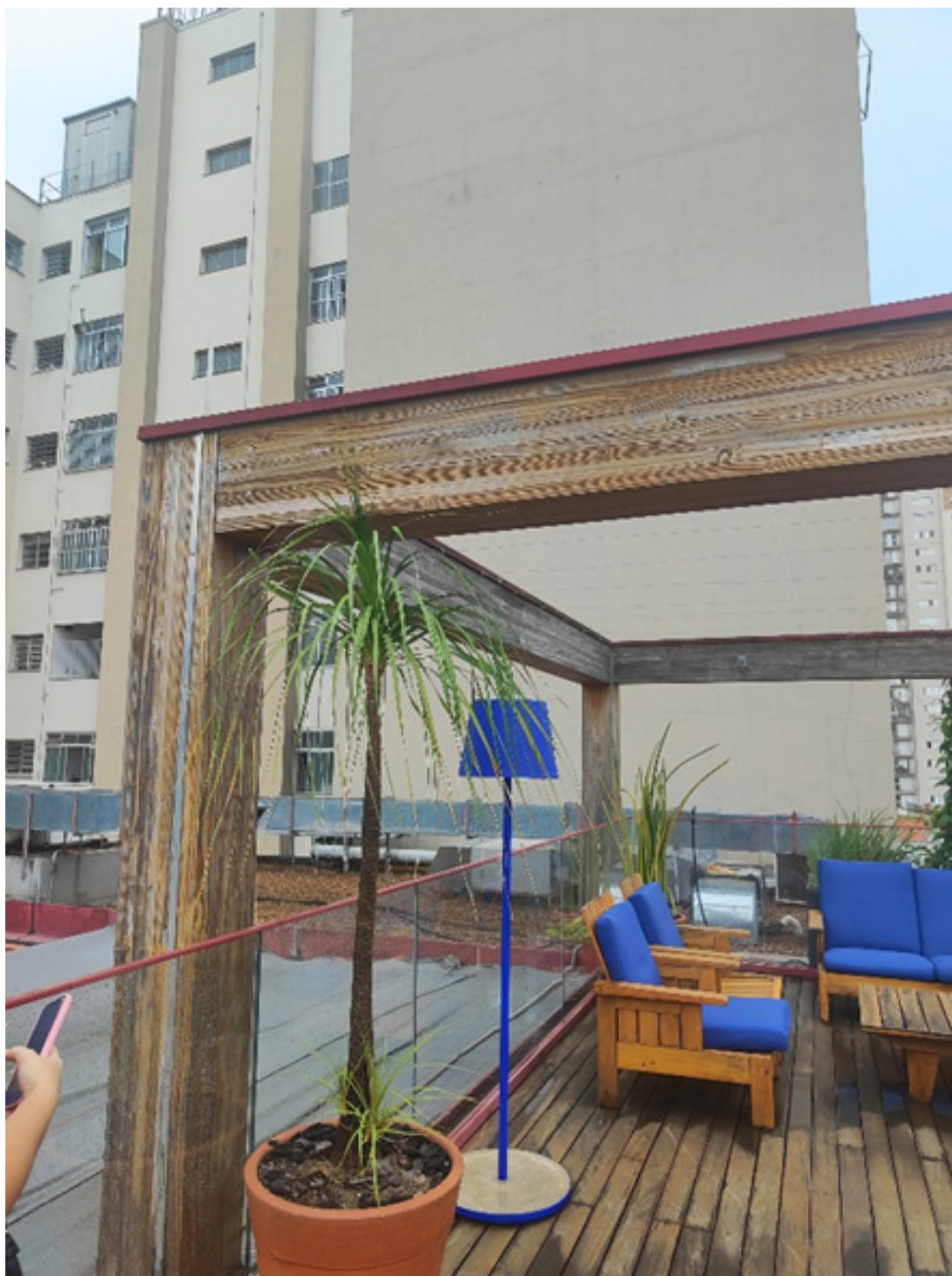
Figura 53 - Estrutura em madeira lamelada colada cruzada na área externa da Fábrica de Chocolate Dengo - Madeira exposta às intempéries.
