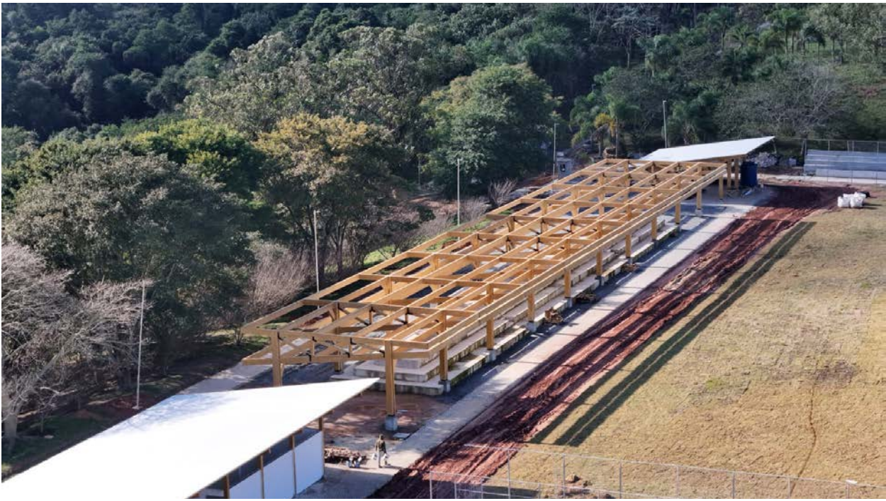
Figura 15 - Núcleo esportivo em obras: cobertura em MLC para a arquibancada. Foto antes da instalação dos rufo e sombrite.
