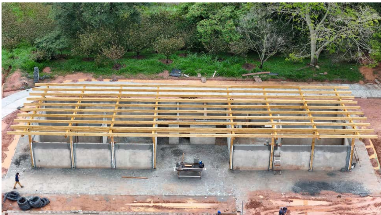
Figura 23 - Núcleo esportivo em obras: montagem da estrutura em MLC para os vestiários.
