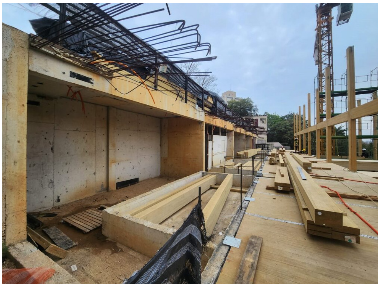
Figuras 45-47 - Modulação de pilares e vigas em MLC e sua montagem em obra.
