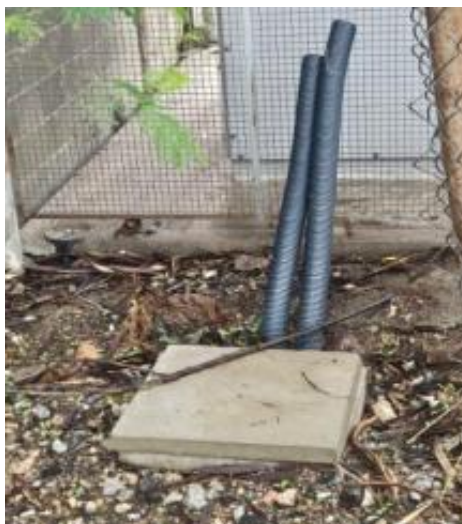
Caixas de passagem.
